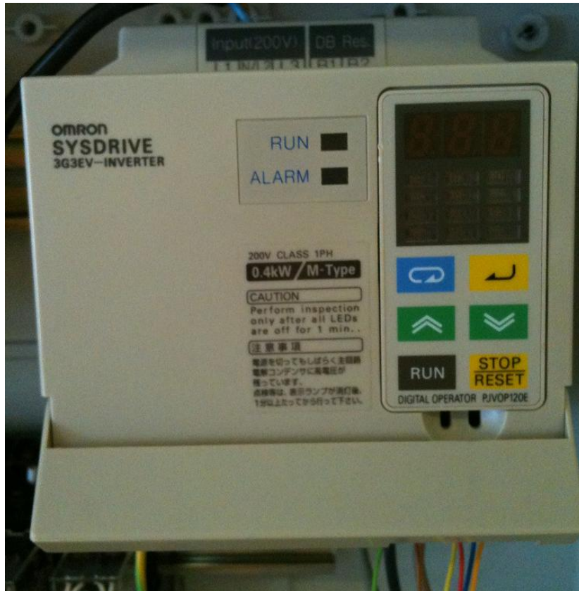
KUVA 9 Taajuusmuuttaja Omron Sysdrive 3G3EV
