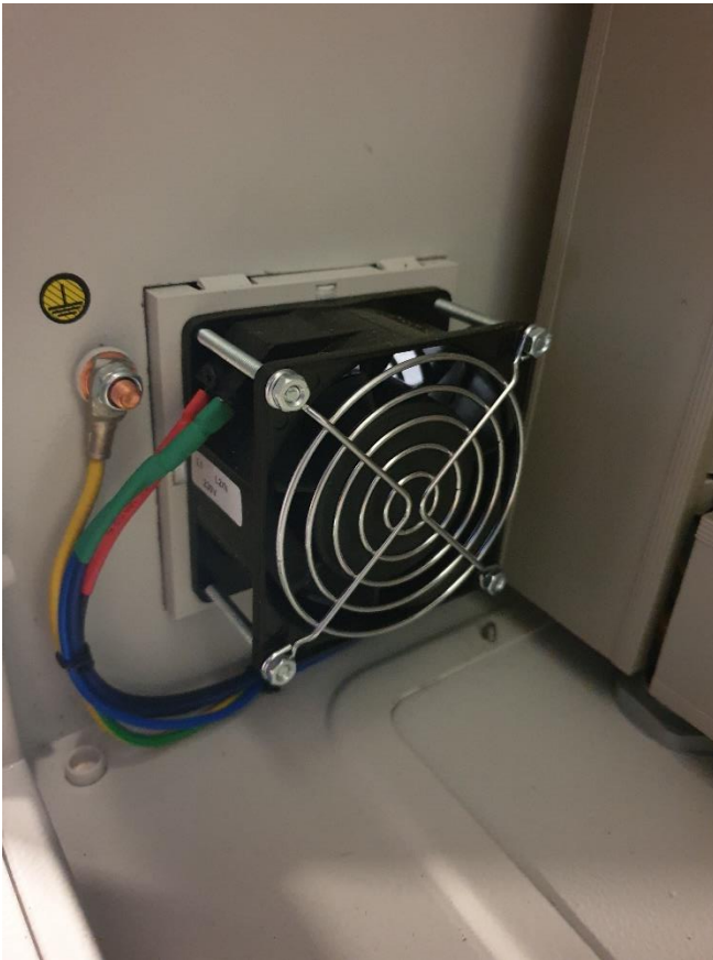
KUVA 9. Ohjauskeskukseen asennettu kojeistotuuletin
