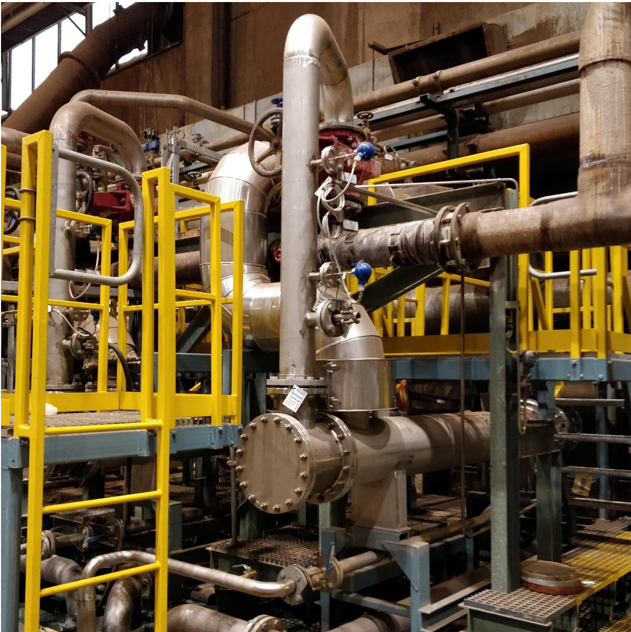
KUVA 4. Puhdistamon lämmönvaihdin putkistoiineen
