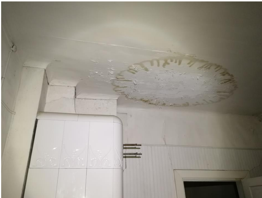
Kuva 19. Eteläpään huoneiston tulevan pesuhuoneen yläpohjan kosteusvaurio.
