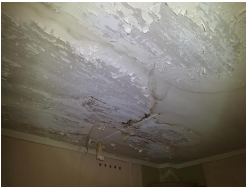
Kuva 22. Keskimmäisen asunnon tulevan pesuhuoneen yläpohjan kosteusvaurio.
