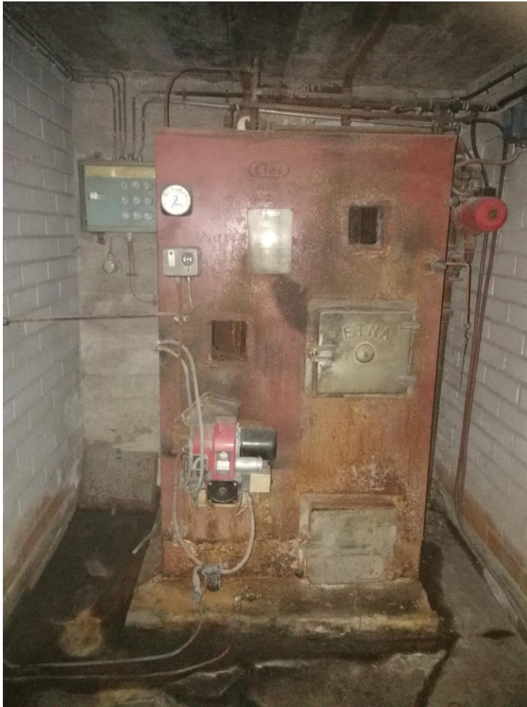
Kuva 12. Käytöstä poistettu vanha öljykattila.
