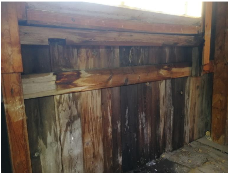
Kuva 17. Ullakon eteläpään ikkuna on vuotanut ja kastellut seinälaudoituksen.
