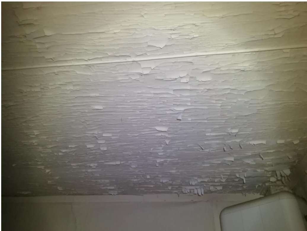
Kuva 21. Keskimmäisen asunnon makuuhuoneen alakaton maalit irronneet kosteusrasituksen vuoksi.
