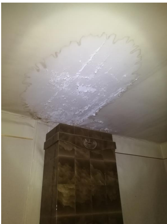
Kuva 20. Eteläpään huoneiston salin yläpohjan kosteusvaurio.
