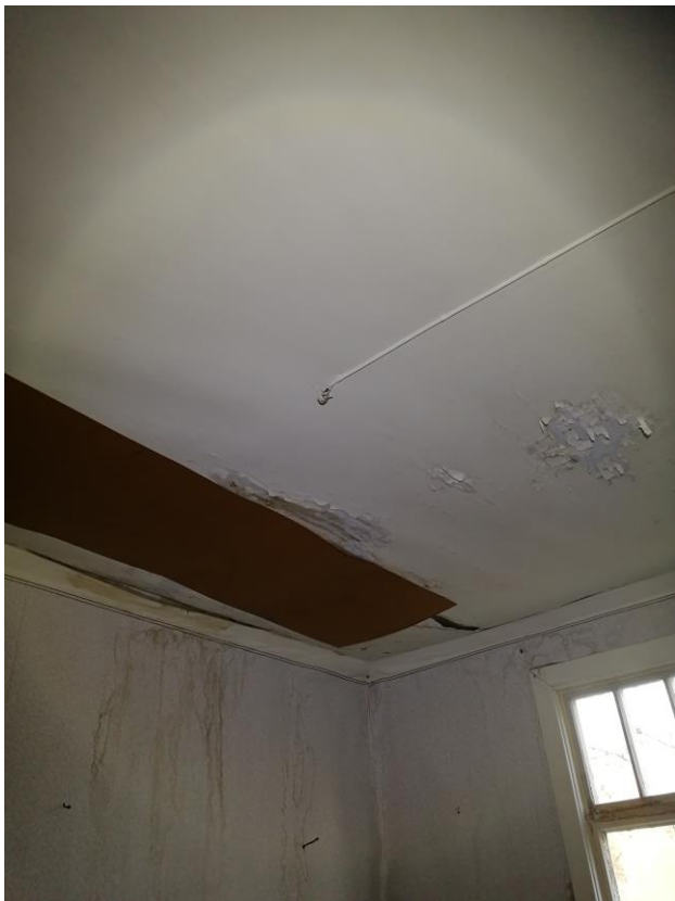
Kuva 23. Pohjoispään asunnon makuuhuoneen yläpohjan kosteusvaurio.
