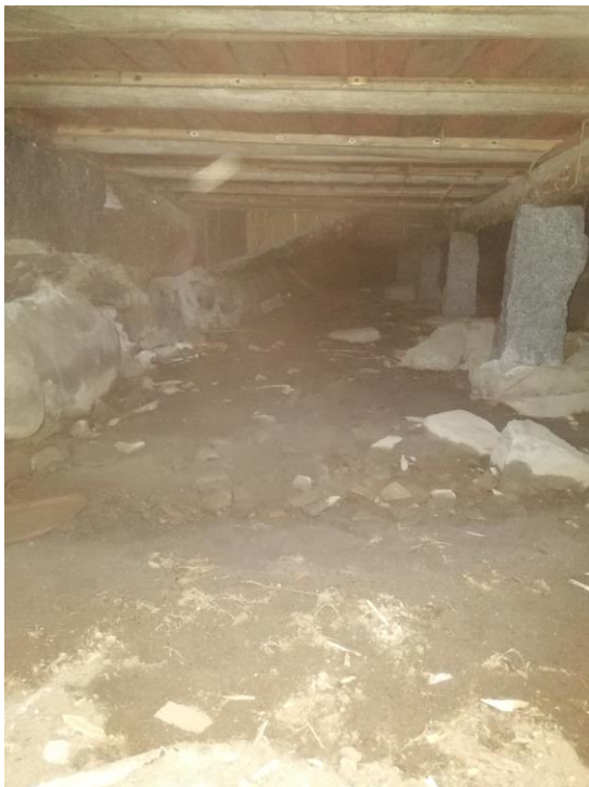
Kuva 6. Maapinnan kaadoista johtuen sade- ja sulamisvedet kerääntyvät ryömintätilan itäpuolelle noin 40 m 2 alueelle.
