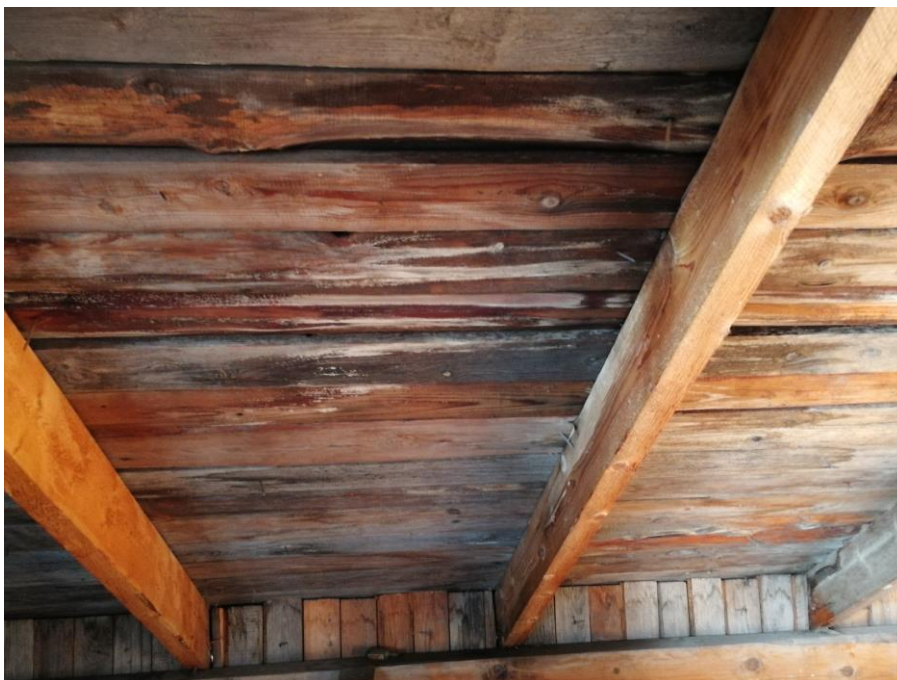
Kuva 26. Eteläpään lännenpuoleisen lappeen vaurioitunut alue.
