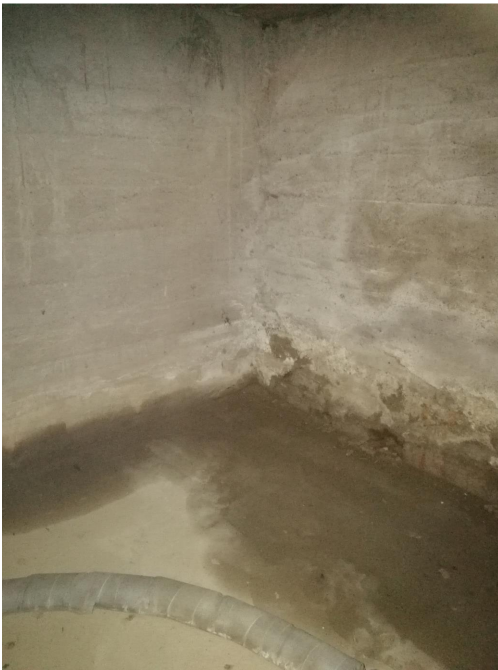
Kuva 11. Eristetty vesijohto ja silminnähtävää kosteutta myös betonilaatassa.
