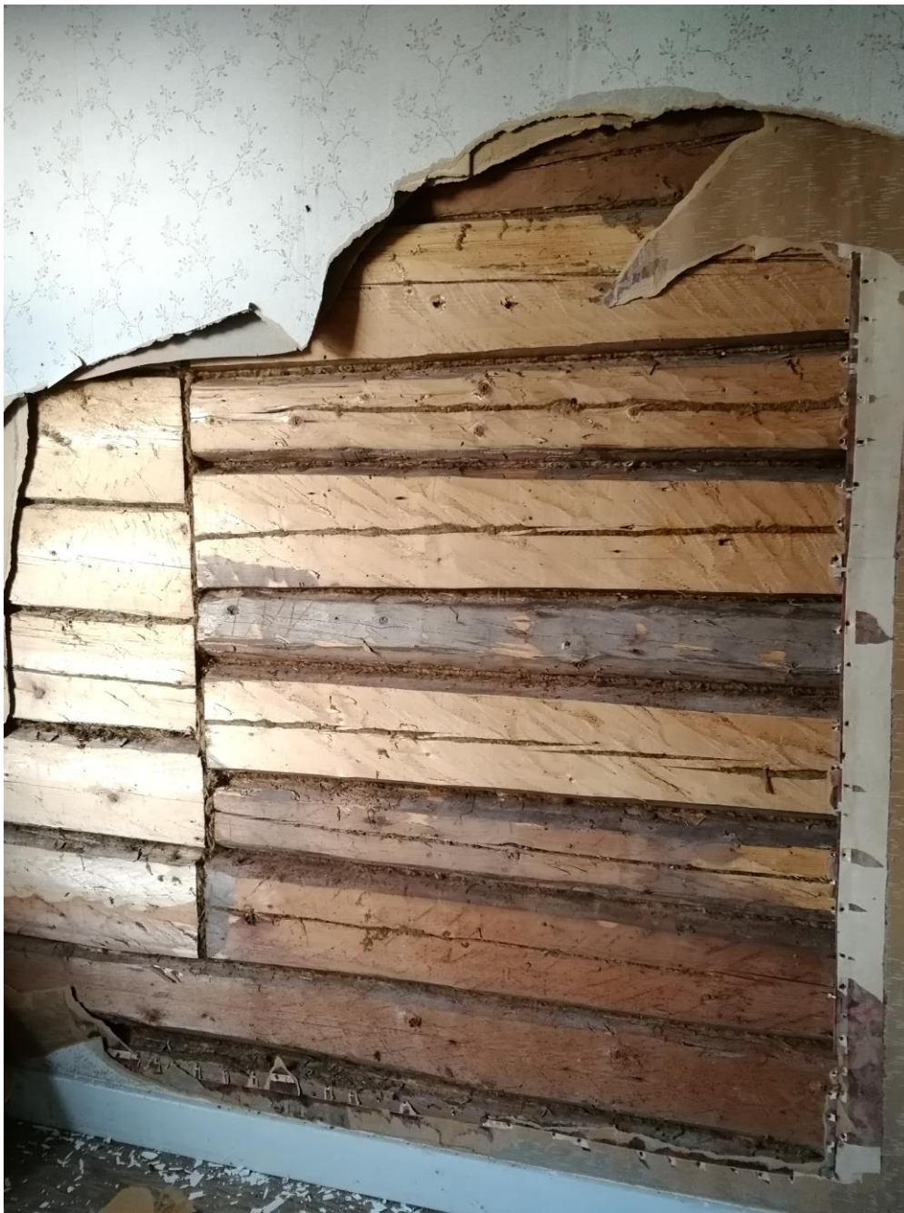
Kuva 16. Hirsiseinän kunto pohjoispään seinällä.
