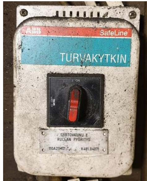
Kuva 7. HA1 siirtovaunun 1:n rullanpyörityksen sähkömoottorin turvakytin
