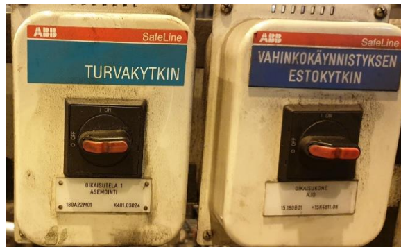
Kuva 14. Sähkölukituksen turvakytkin ja vahinkokäynnistyksen estokytkin
