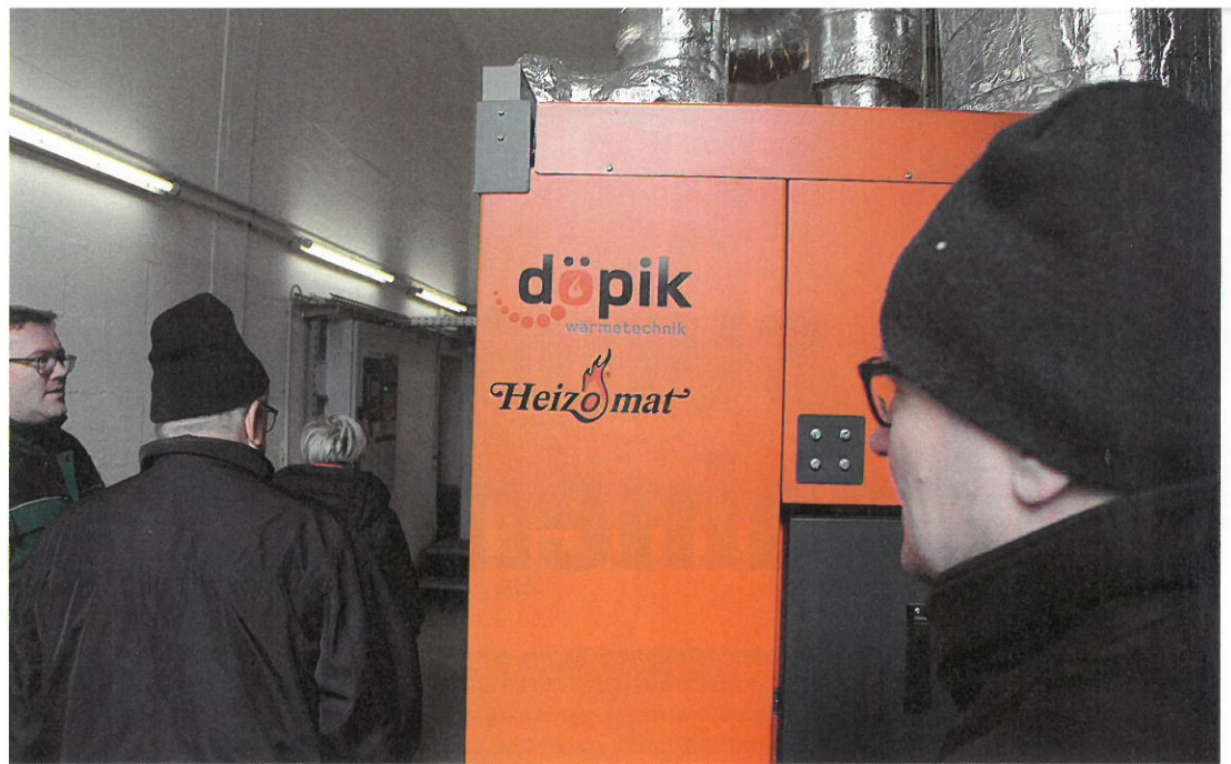
↑ Osuuskunnan 800 kW hakekattila. (Kuva: Kari Laasasenaho)
