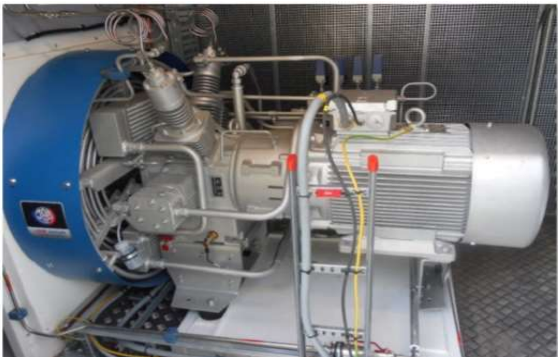
Figur 16. Tankningsstationens kompressor. Tekniska data finns i bilaga 2.
