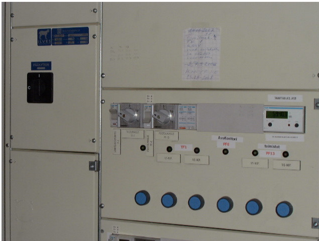
Kuva 14. Keskuksen JK-12 kwh-mittarin ja virtamuuntajien sijoittelu. Virtamuunta- jat nuolen osoittamassa kennossa.
