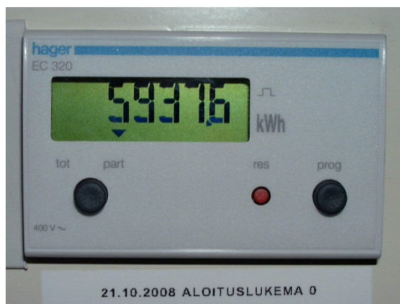
Kuva 13. Keskuksen JK-12 asennettu mittari (Hager EC 320)
