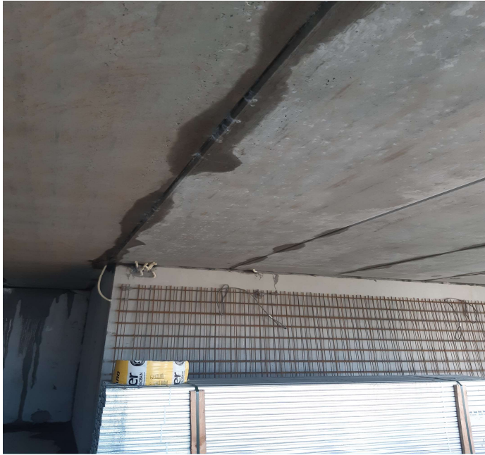
Kuva 2. Paikalleen asennetun ontelolaatan kieroudesta johtuva hammastus havaittavissa silmällä.
