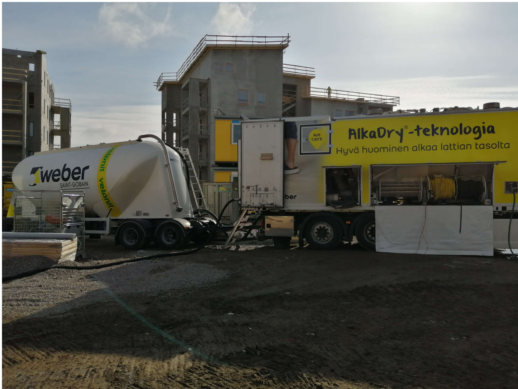
Kuva 12. Kuvassa lattiatasoitteen pumppaamiseen käytettävä pumppuauto, sekä sen perässä säiliö, jossa lattiatasoitteen valmistukseen käytettävää sementtipohjaista kuiva-ainesta.
