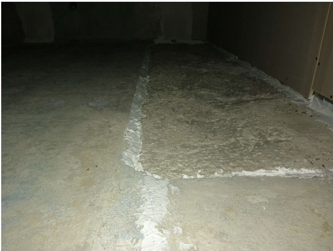
Kuva 14. Kuvassa havaittavissa, että valun pinta on selkeästi ontelolaatan pintaa alempana.
