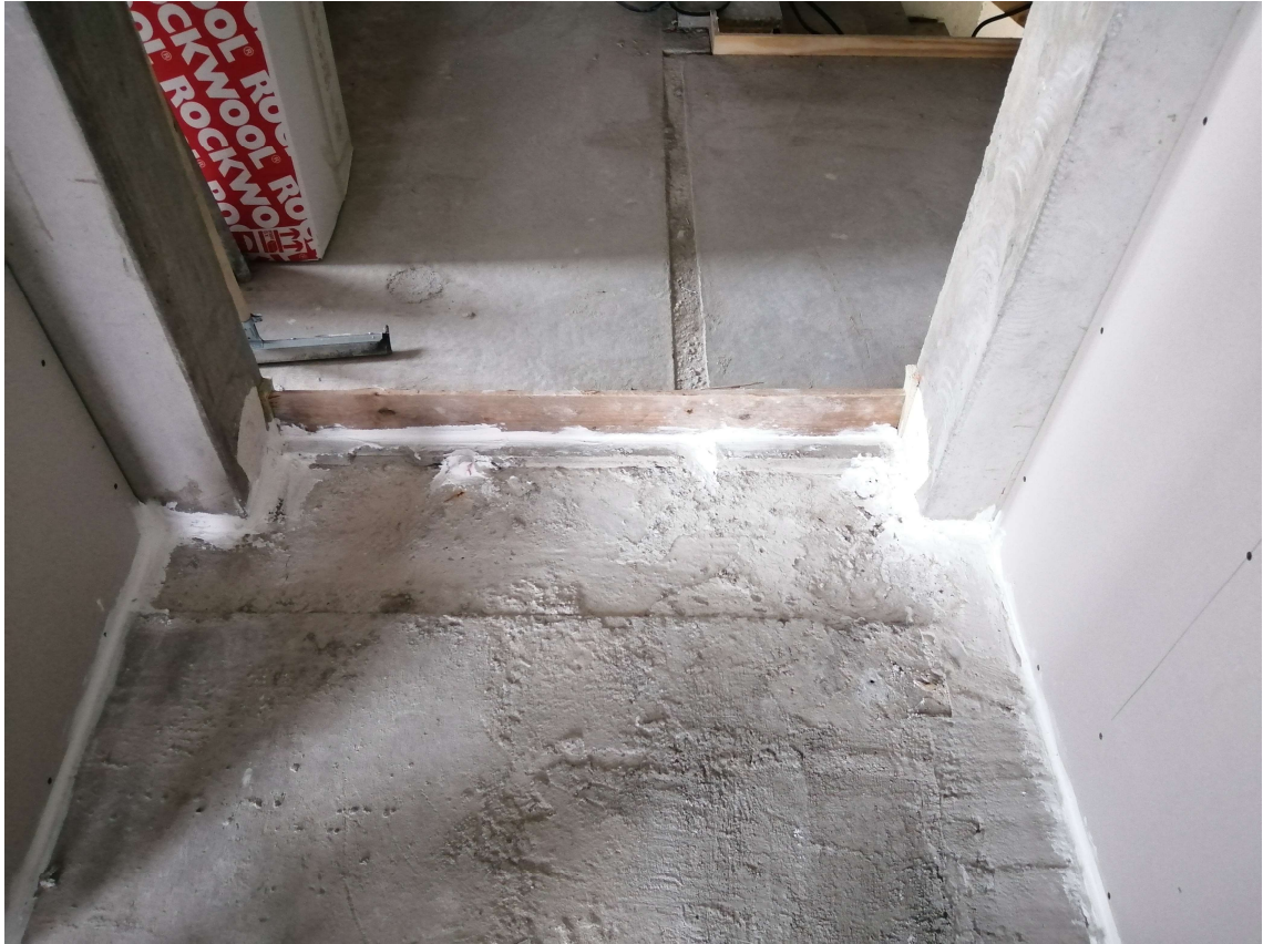
Kuva 5. Kuvassa näkyvissä laudasta tehty tuke, huoneiston ja käytävän välillä.
