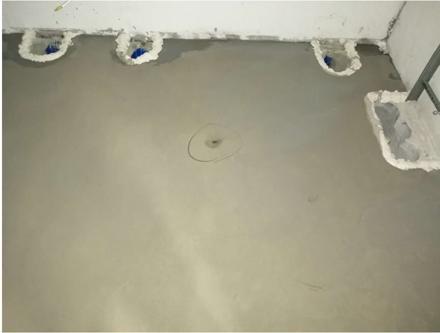
Kuva 13. Kuivunut lattiatasoite on vaalean harmaa. Lattiaan ympyröity mustalla lattiatasoitteen vuotokohta.
