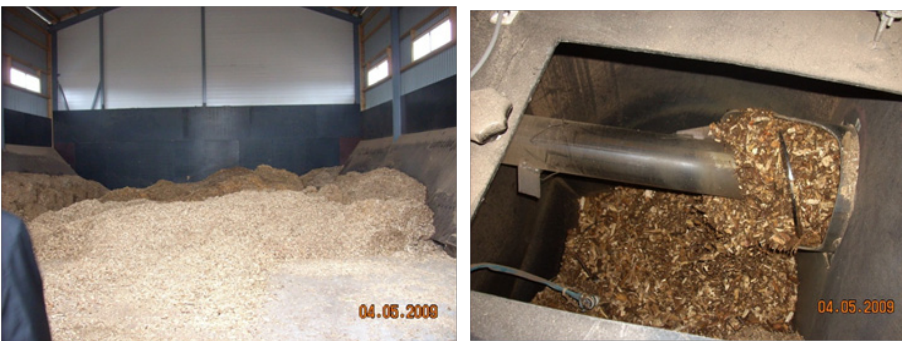
Kuva 3.2. Hakevarasto ja kattilahuoneessa oleva syöttökammio syöttöruuveineen. Kuvat: Martti Härkönen
