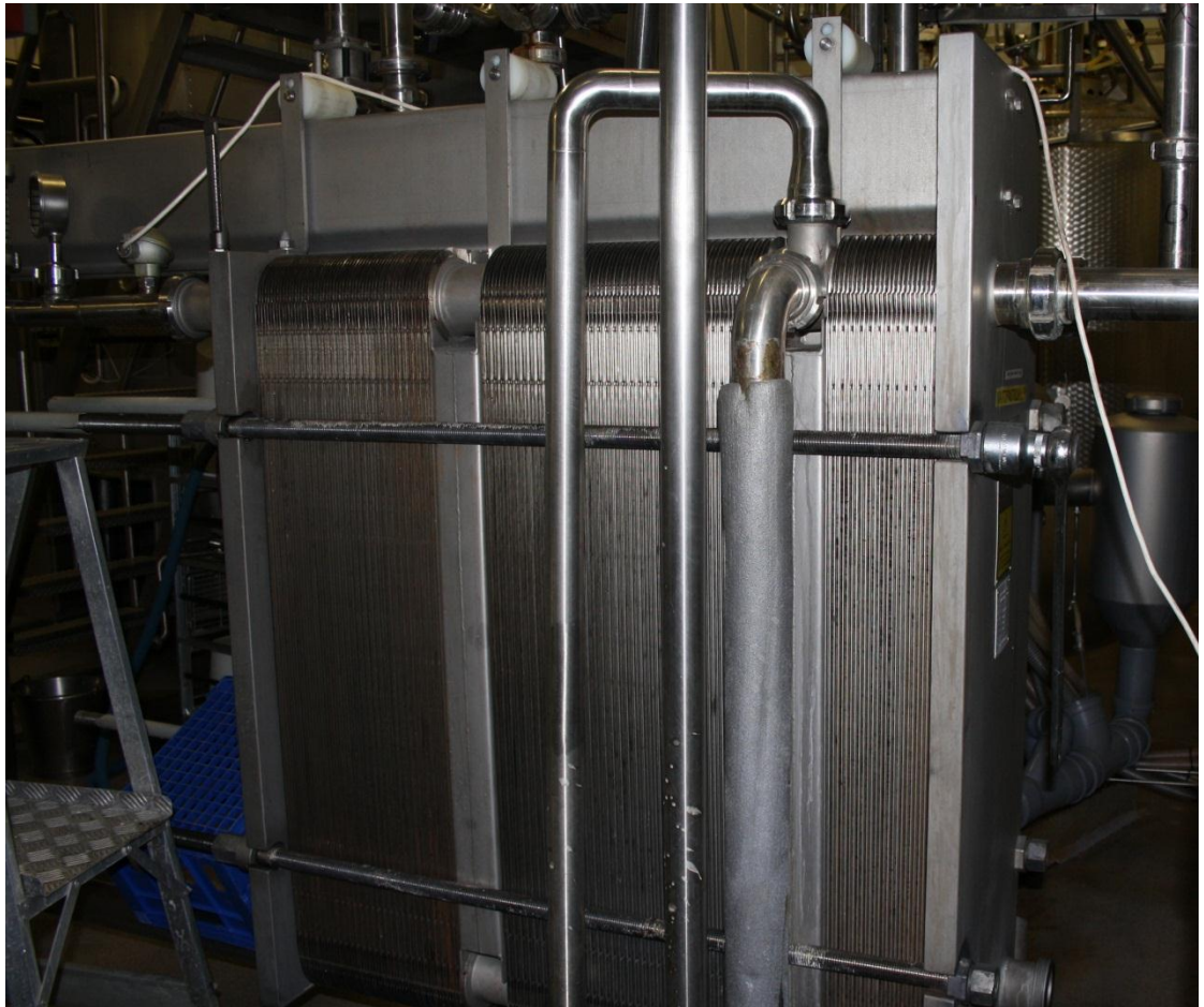
KUVA 6. Maidon kuumentamiseen tarkoitettu lämmönsiirrin
