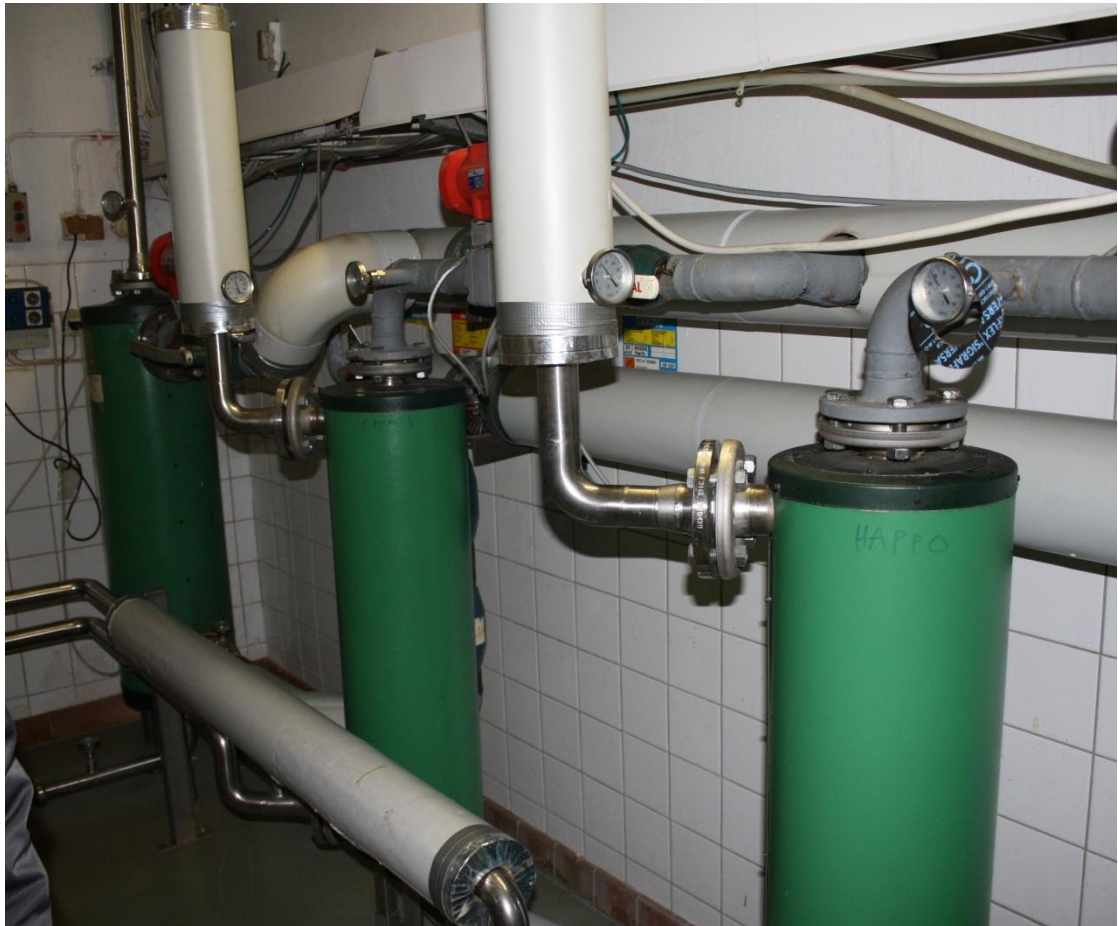
KUVA 7. Pesunesteiden lämmönsiirtimet (happo, emäs ja vesi).
