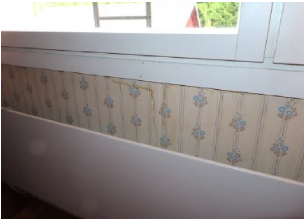
Kuva 16. Makuuhuoneen kosteusjälki (Syrjämäki, 2021).
