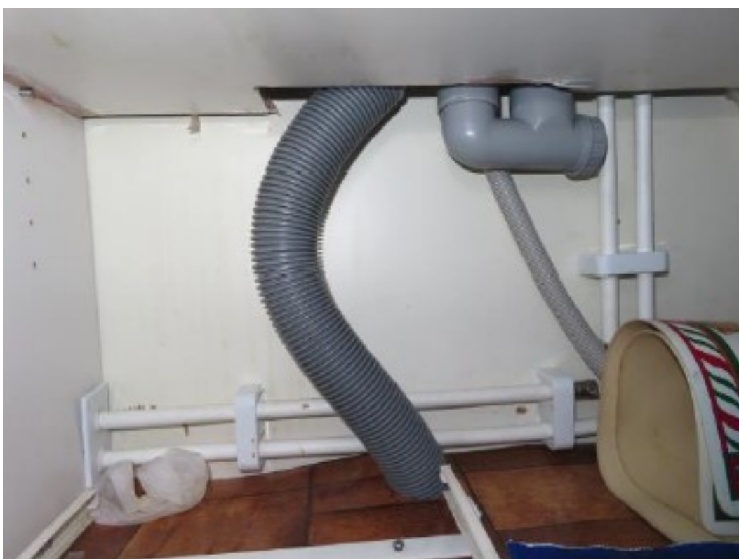
Kuva 13. Allaskaappien putkistot (Syrjämäki, 2021).
