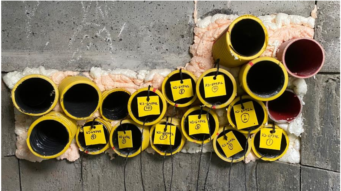
KUVA 35. Kaapelinsuojausputkia merkittyinä kaivossa (Kari Kuuttila 2023).
