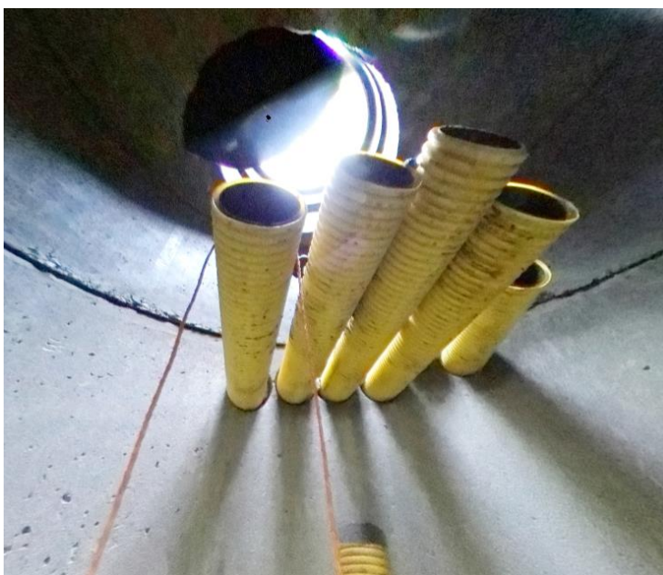
KUVA 30. Lyhentämättömiä putkenpäitä kaivossa kulkuaukon edessä (Raitiotieallianssi 2020).
