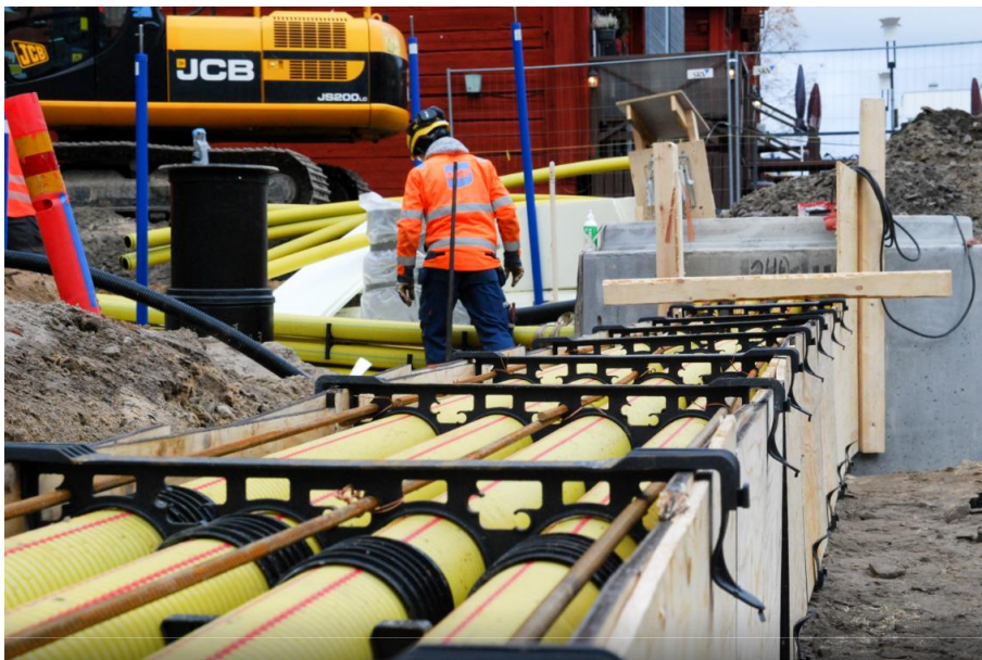
KUVA 8. OPI-kanaalijärjestelmä Oulun Aittatorilla 2017 (Pipelife 2017).
