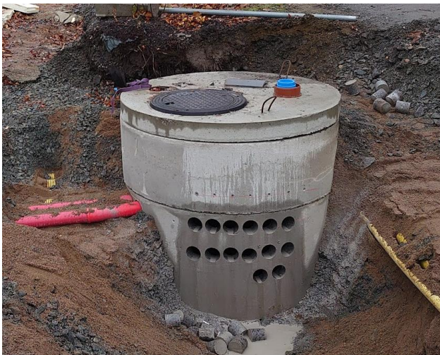
KUVA 11. Johto-omistajien halkaisijaltaan 1500 mm:n kaapelikaivo (Raitiotieallianssi, Jukka Heinonen 2022).
