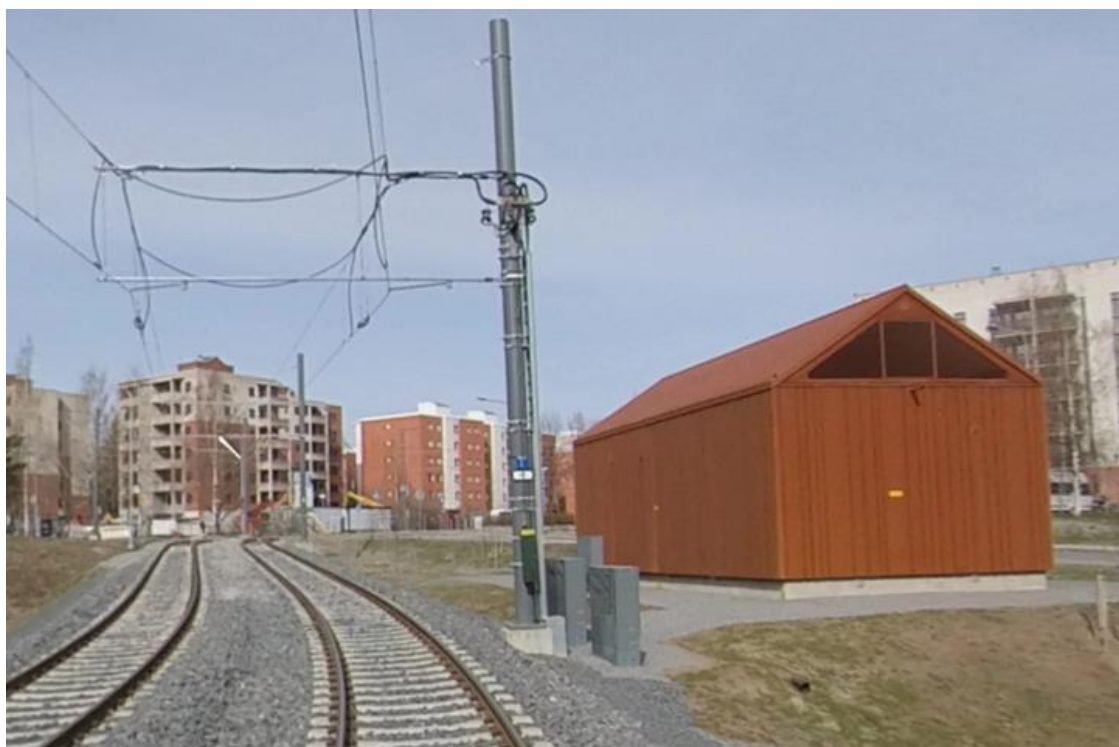
KUVA 14. Sähkösyöttöasema ja syöttöpylväs sekä syöttöpiste- ja paluuvirtako- telot (keskuksat) Hervannassa (Raitiotieallianssi, Hely-Anna Mäki 2021).
