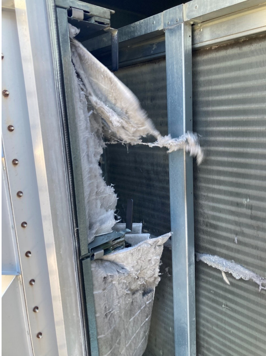
Kuva 2. Tuloilmakoneen ilmansuodatin keväällä 2023. Eero Nissinen.
