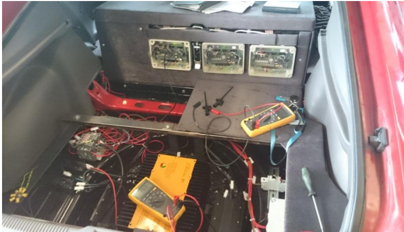
KUVA 17. Toimiva TC Charger lataamassa
