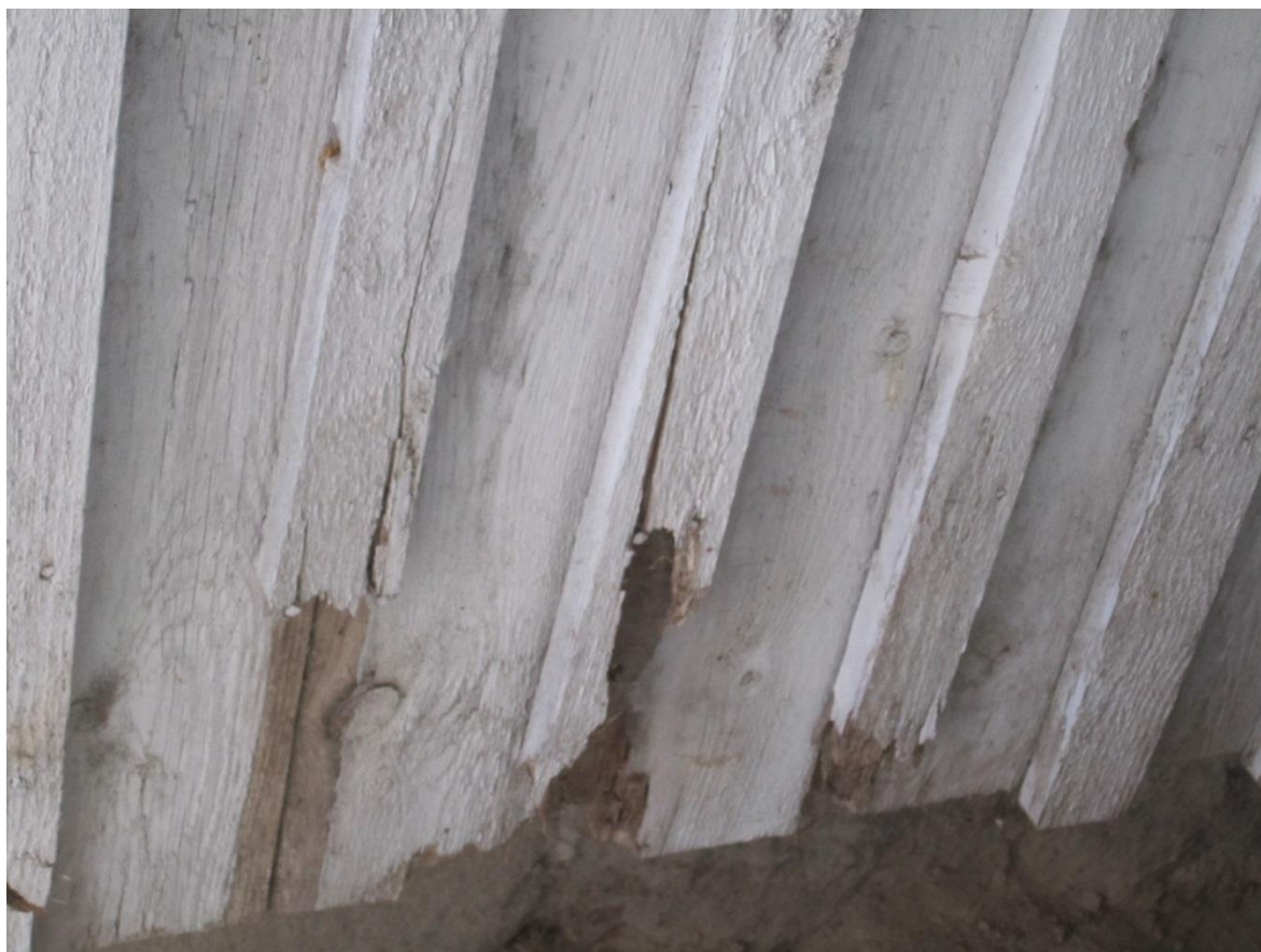
Kuva 5. Julkisivun laudoituksen vaurioita.
