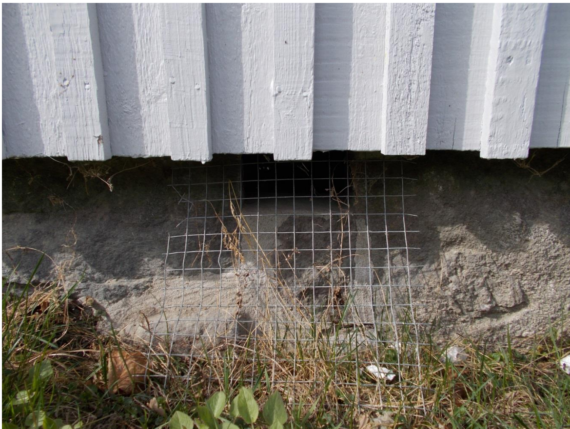
Kuva 4. Ulkovuoraus peittää tuuletusluukun.
