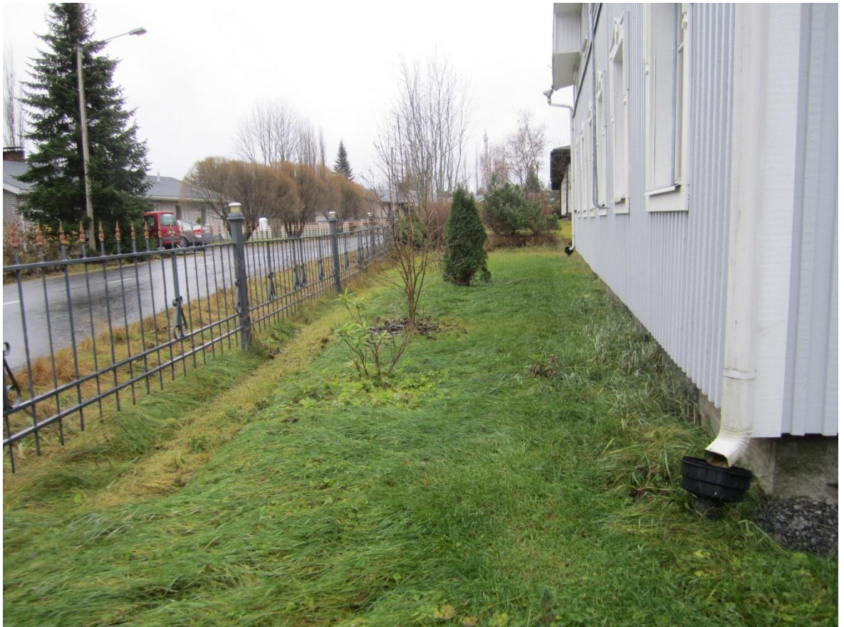
Kuva 2. Maanpinta viettää taloon päin.
