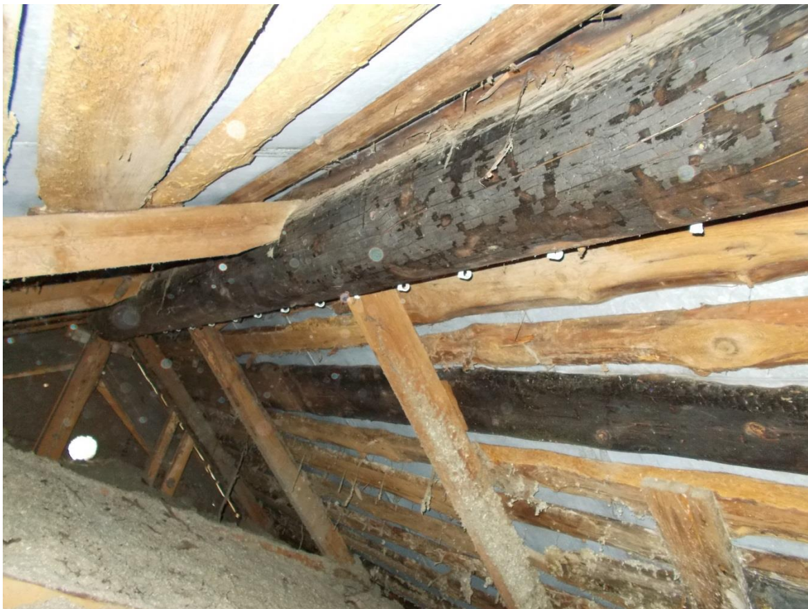
Kuva 9. Nokipalon jälkiä kurkihirressä.
