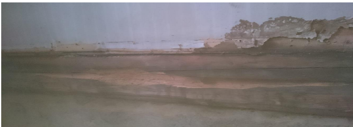
Kuva 14. Levyn takaa paljastunut vesipatterin vuoto.
