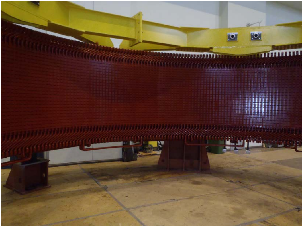
KUVA 3. Vesivoimakoneen generaattorin staattori
