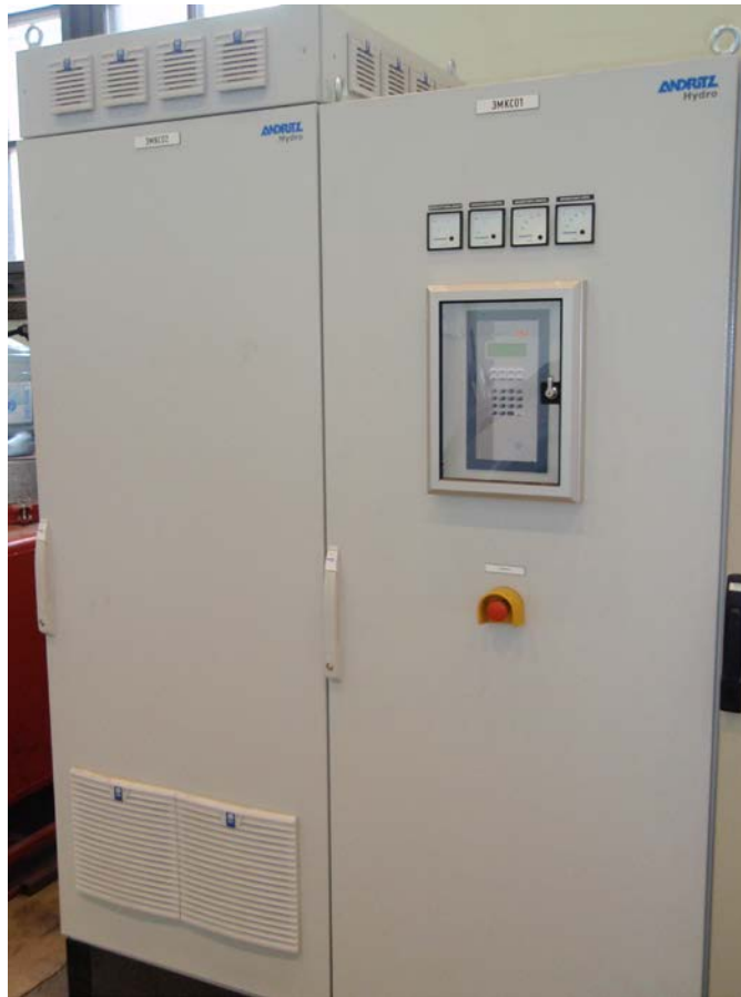
KUVA 20. THYNE 5-magnetointijärjestelmän laitekaapit
