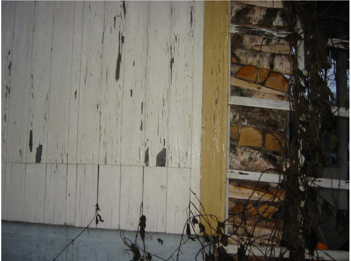
Kuva 4. Eteläpäädyn maalin rapistuminen, sekä uusittu alalautoitus
