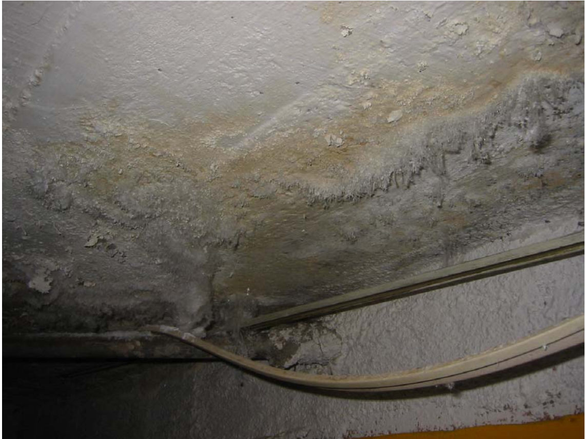
Kuva 2. Kalkin työntyminen kellarin seinän ja katon rajasta
