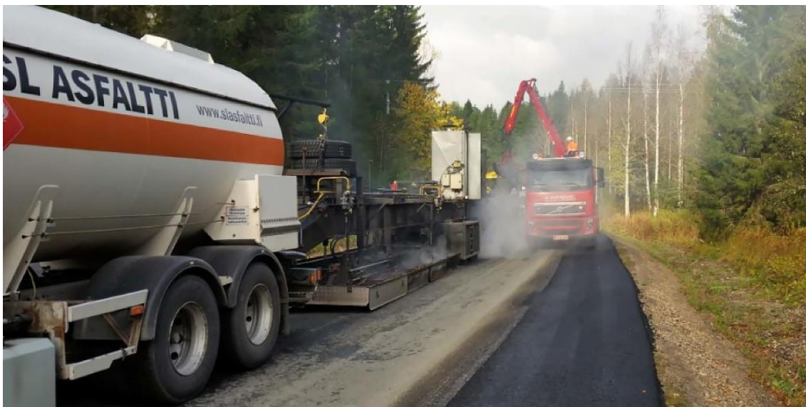
Kuva 5. Reunapainumien korjausta. Oikealla on jo korjattu painuma sekä nosturiauto ja vasemmalla säteilylämmitin.
