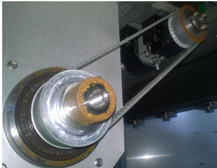
Kuva 3. Optisen kuidun kuitutornin hihnapyörät ovat alumiinia ja niihin on päälle asennettu teräslaippa. Voimakasta ruostetta on näkyvissä kyseisessä osassa sekä ruostumattomasta teräksestä valmistetun akselin päässä. Haitta on toistaiseksi esteettinen. (7.)
