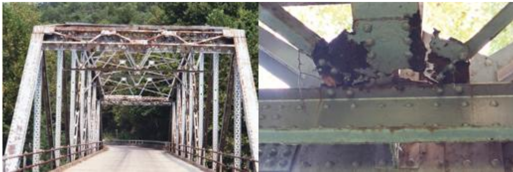
Kuva 1. Devil's Elbow Bridge, Missouri, Yhdysvallat. Sillan rakenne on ruostunut puhki. (4)
