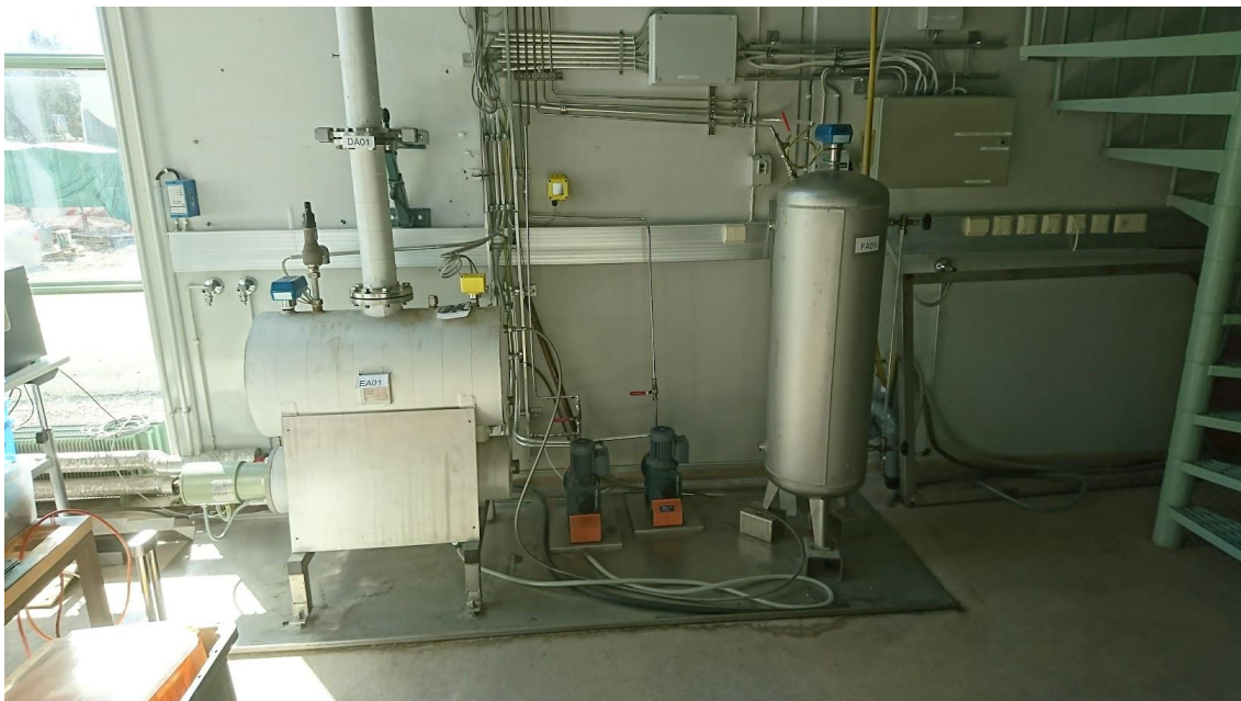
Kuva 15. Tislauslaitteiston syöttösäiliö, syöttöpumppu ja pohjankiehutin
