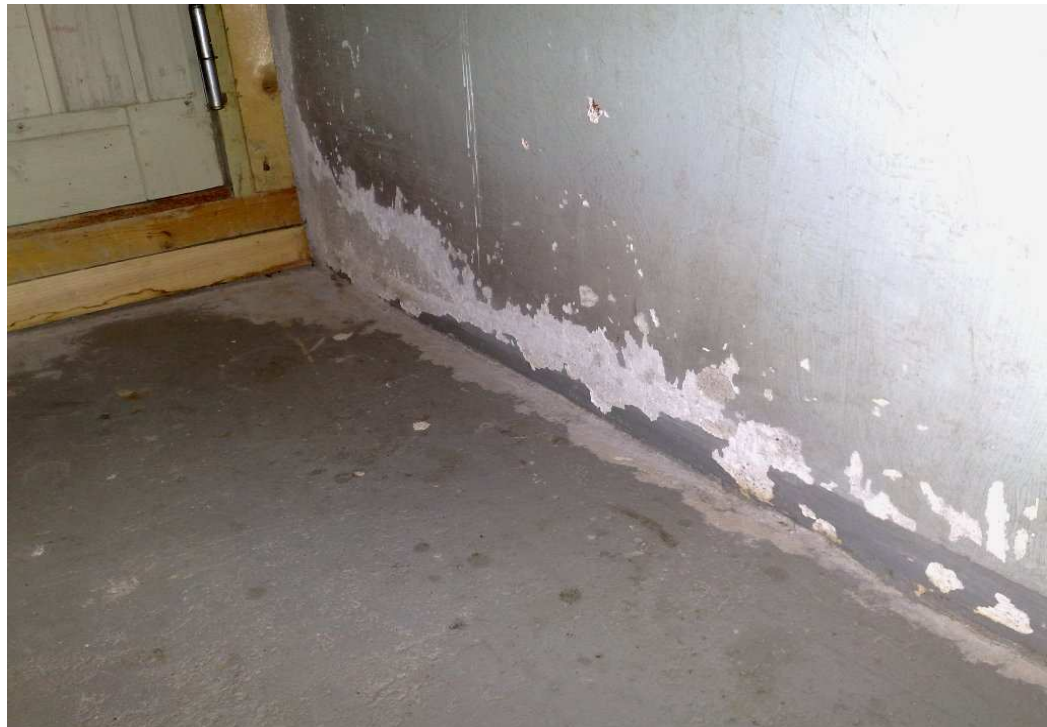
Kuva 12. Kosteusvauriojälkiä kellarikerroksen runkobetonissa.
