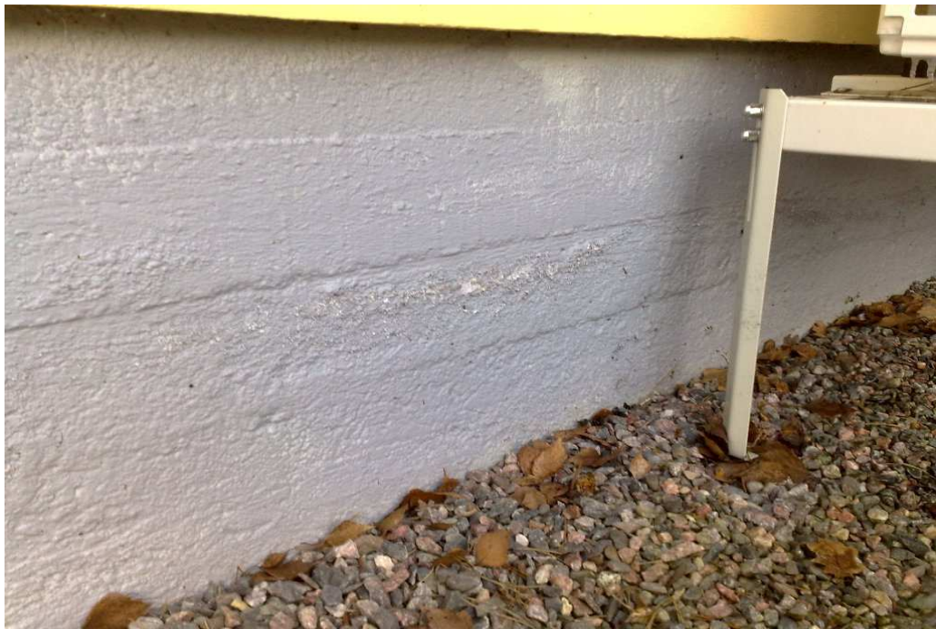
Kuva 14. Kosteuden aiheuttamat jäljet sokkelissa.
