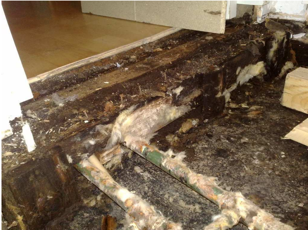
Kuva 13. Putkivuodosta aiheutunut lattian koolauspuiden vaurioituminen.
