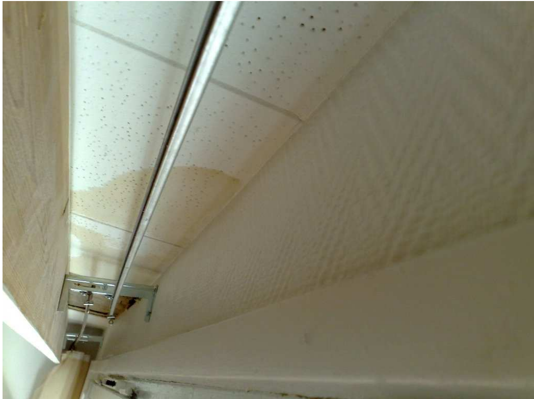
Kuva 11. Kosteusvauriojälkiä verhokotelon sisällä katossa.
