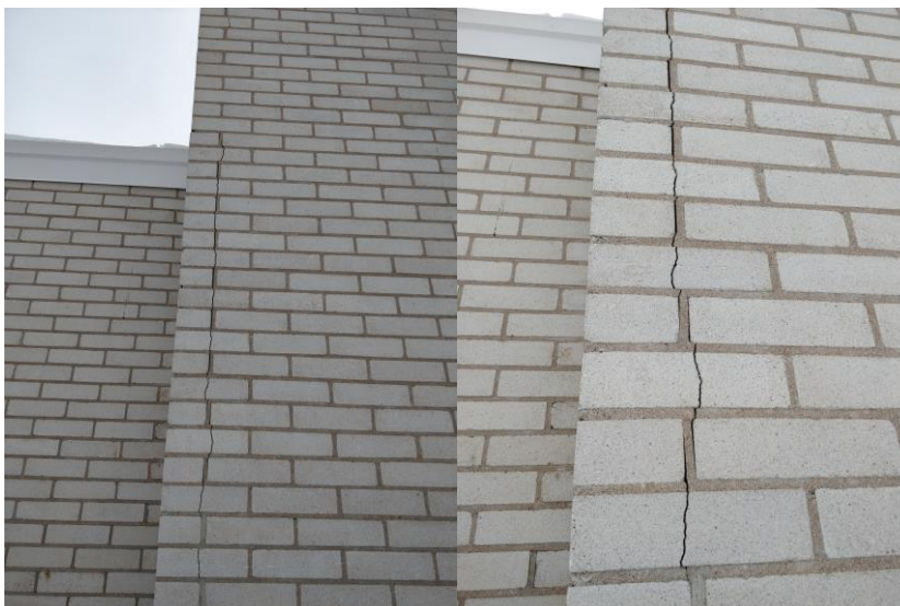
Kuva 28. Tiiliseinässä halkeamia (Valokuva, Johannes Määttä)
