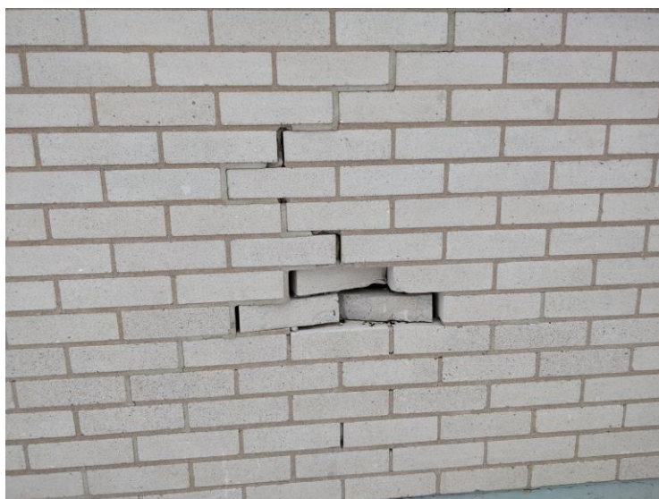
Kuva 27. Tiiliseinässä irtonaisia tiilejä (Valokuva, Johannes Määttä)
