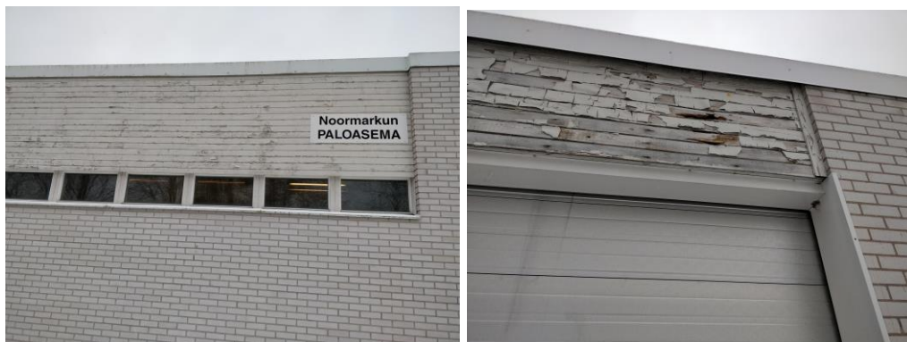
Kuva 26. Ulkoverhouslaudat huonossa kunnossa (Valokuva, Johannes Määttä)
