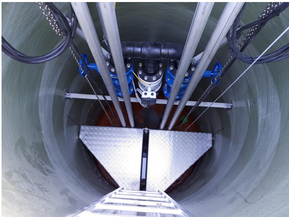
KUVA 2. Jätevesipumppaamo (Kangasalan kaupunki 2019).
