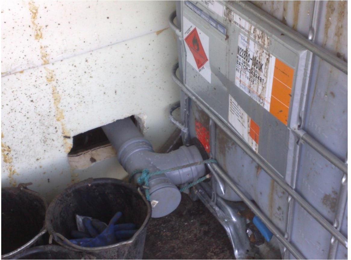
KUVA 11. Jätevesilietesäiliöiden välille asennettu yhdysputki.
