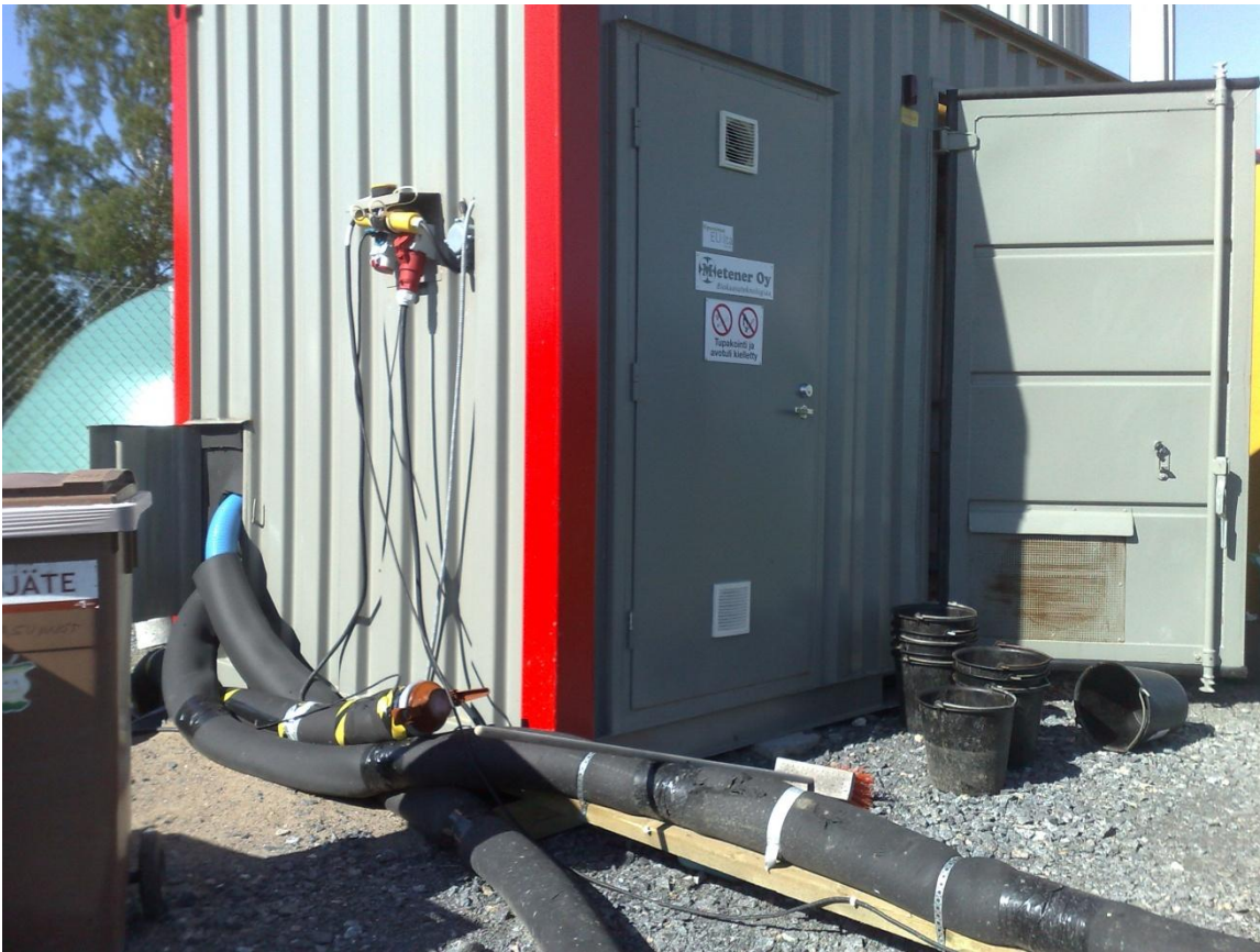
KUVA 9. Pumppujen putki- ja sähkökytkennät mobiililaitokseen.
