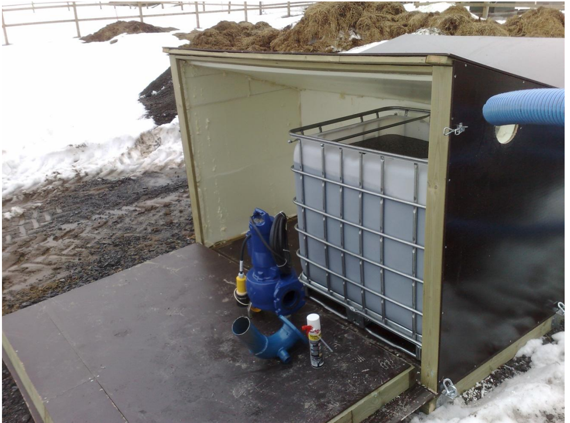
KUVA 8. Uppopumppu ennen säiliöön upottamista ja laitokseen kytkemistä. Etualalla pumpun imuputki ja siihen hitsattu sekoitushaarakappale.
