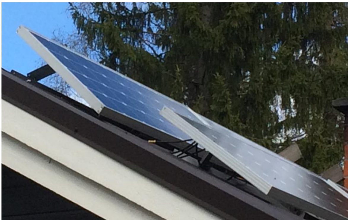
KUVA 16. Aurinkopaneelin kulma muuttunut lumen painosta (Airaksinen 2019-04-25.)
