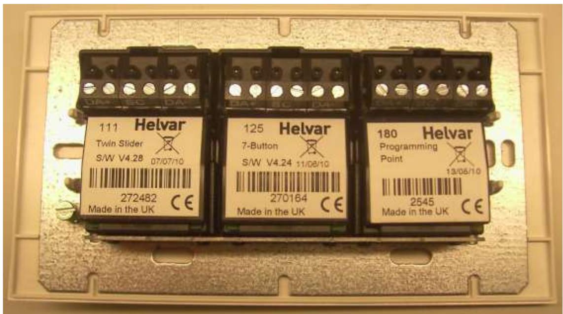
KUVA 13. Vasemmalta lueteltuna kaksoisliukusäädin, 7-painike ja ohjelmointiliityntäpiste peitelevyn alle asennettuna takaapäin kuvattuna (Kuva: Jarno Nurmio 2010)
