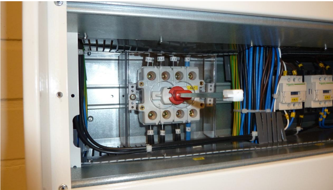
KUVA 10. Jakokeskuksen 4-napainen pääkytkin. (Kuva Juuso Itkonen 2011)
