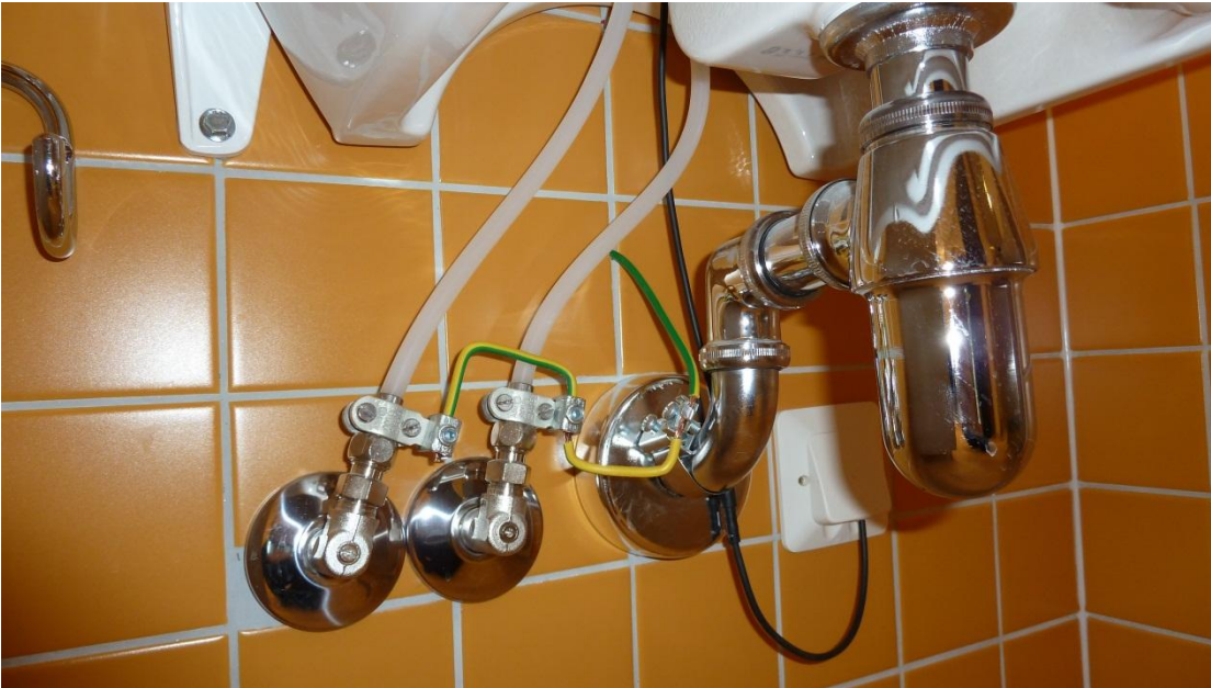
KUVA 6. Vesi- ja viemäriputkien lisäpotentiaalintasaus G1-tilassa. (Kuva Juuso Itkonen 2011)
