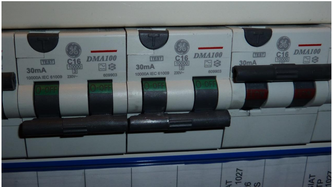
KUVA 11. Jakokeskuksen 2-napaisia vikavirta-johdonsuojayhdistelmiä. (Kuva Juuso Itkonen 2011)
