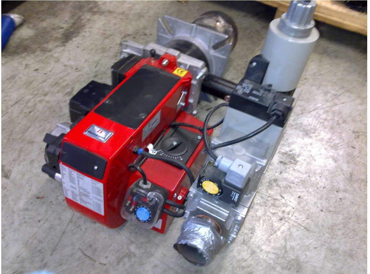
KUVIO 21. Maakaasupoltin. Kuvassa oikealla sulku – ja painentasausventtiili, keskellä palamisilman säätö, vasemmalla puhaltimen moottori ja säätöautomaattikka.
