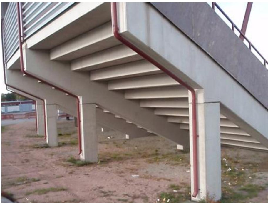
Kuva 4. Porin stadionin katsomon tukipilarit ottavat vastaan vain pystykuormia. Pilarit ovat alapäästään jäykästi tuettuja mutta yläpäästään täysin irtonaisia. Katsomo on ”laskettu” pilareiden päälle.
