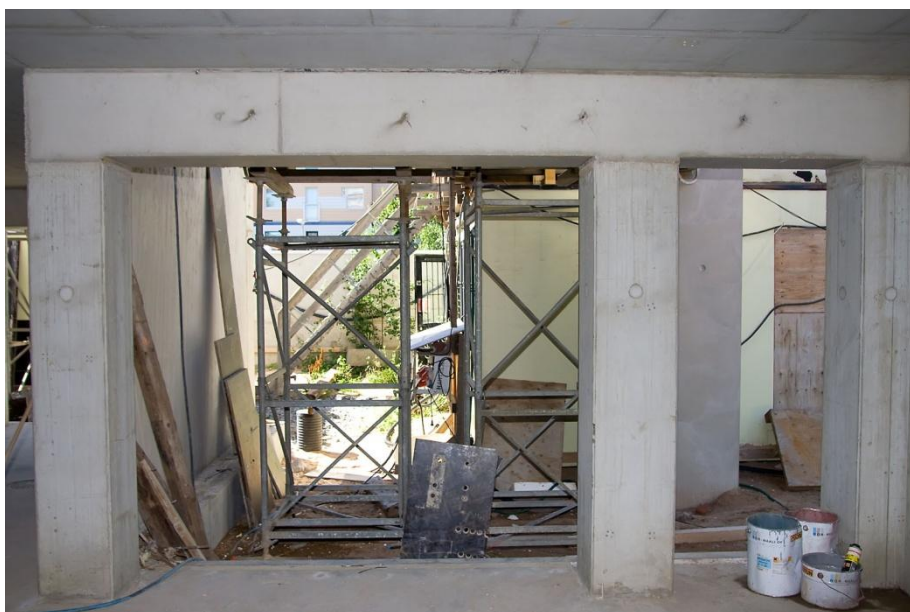
Kuva 10. Palkkiin muodostuu yläpuolisesta laatasta tasainen kuorma (kuvannut Markus Pietilä).
