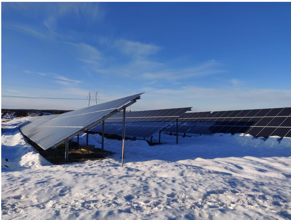
KUVA 4. Toisen voimalan aurinkopaneelit.
