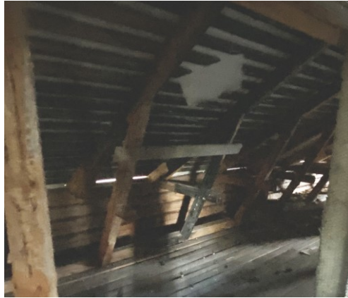
Kuva 15. Paikallisen tulipalon jälkiä yläpohjassa
