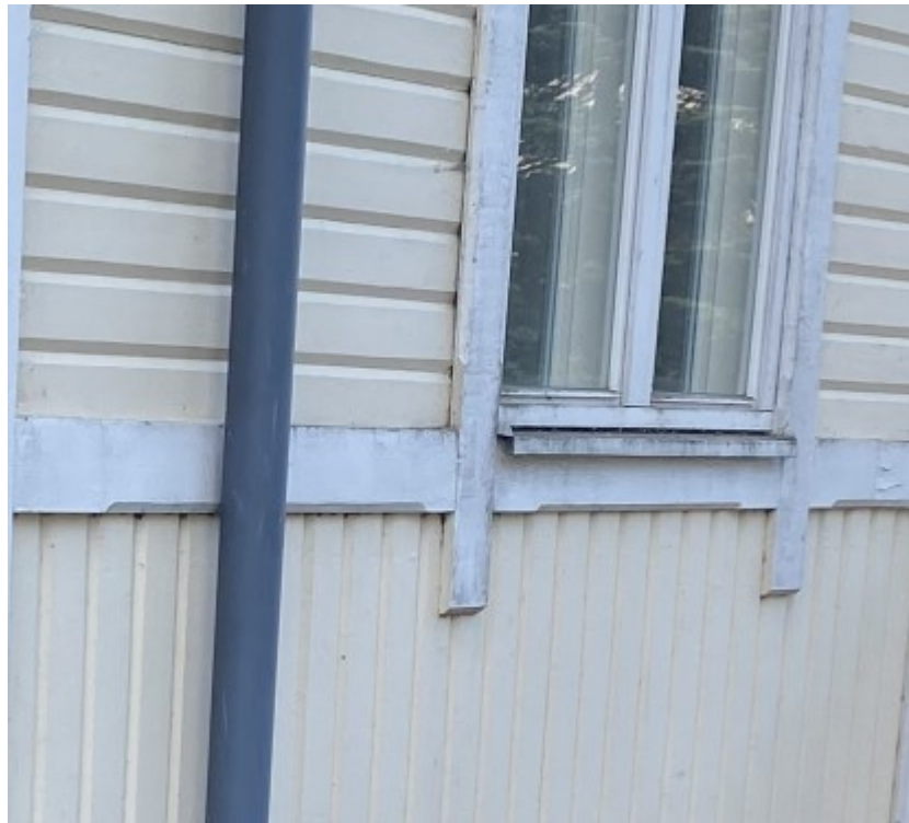
Kuva 13. Ikkunoiden vesipellit eivät kallista pois päin ikkunasta.
