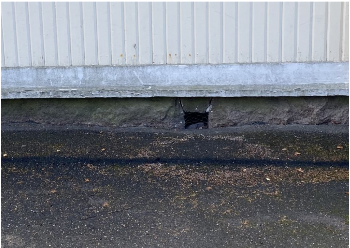
Kuva 9. Nykyiset tuuletusaukot ovat jääneet osin pihan pinnan alapuolelle.
