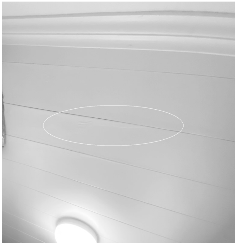
Kuva 14. Nuottihuoneen katon kosteusvauriojälkiä.
