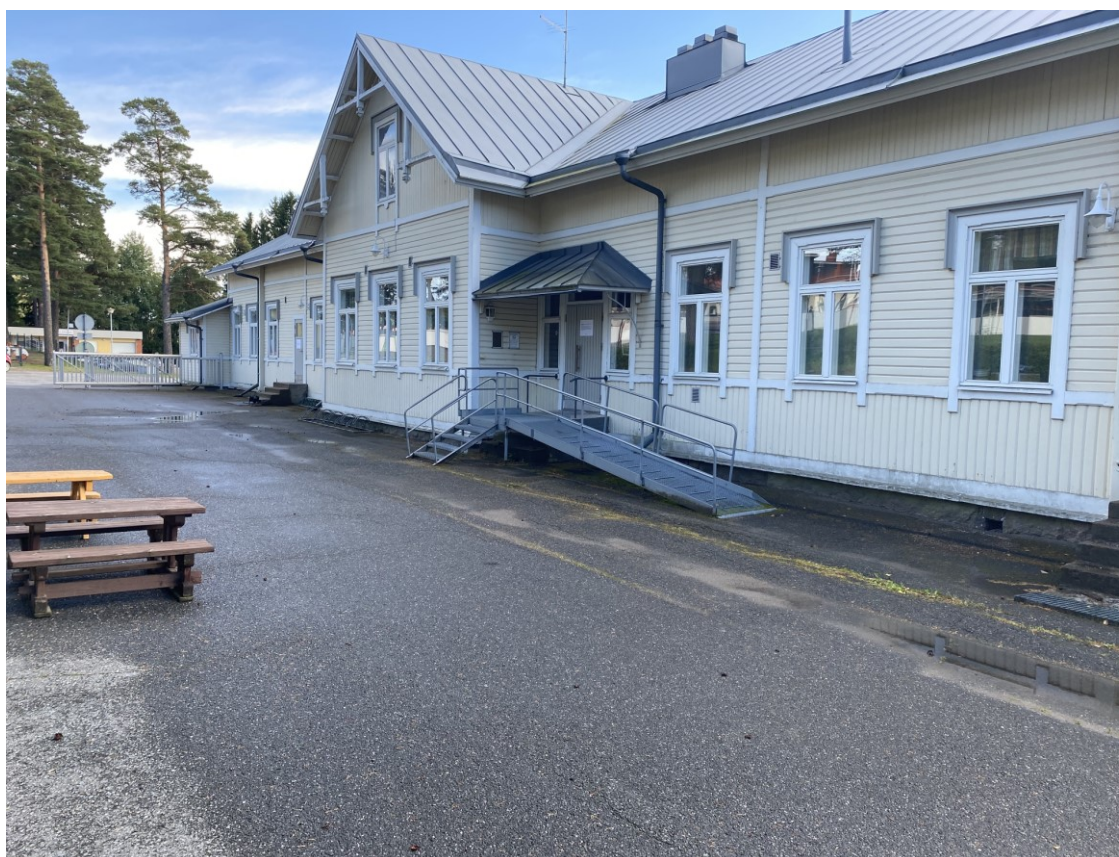
Kuva 8. Vesi lammikoituu, eivätkä pihan kaadot ohjaa vettä pois rakennuksen vierustalta.
