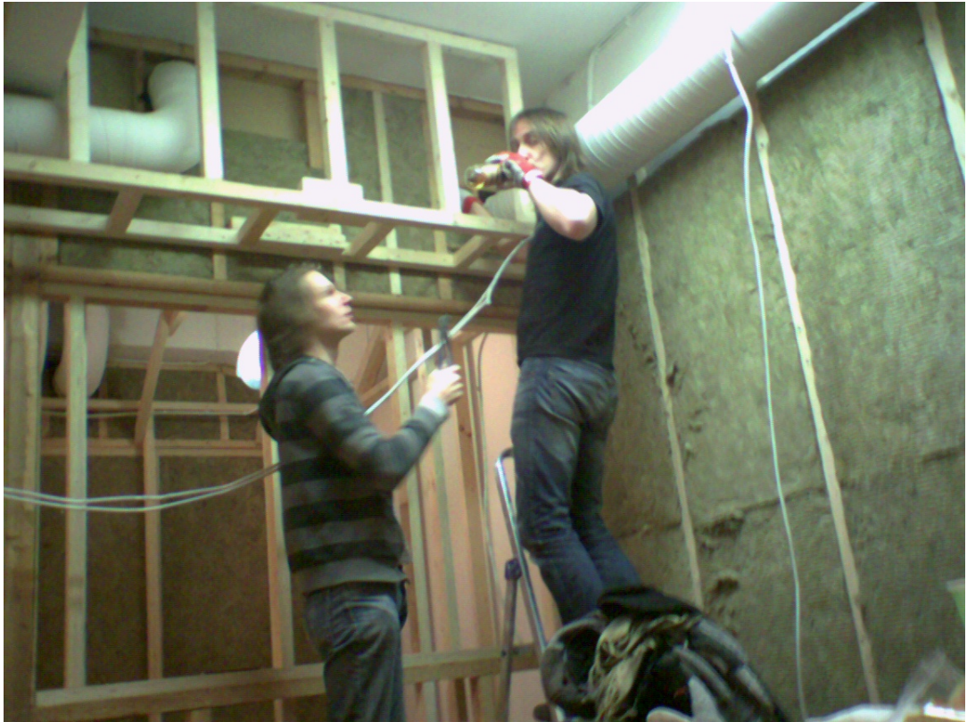
KUVIO 13. Ilmastointikanavien kotelointi.
