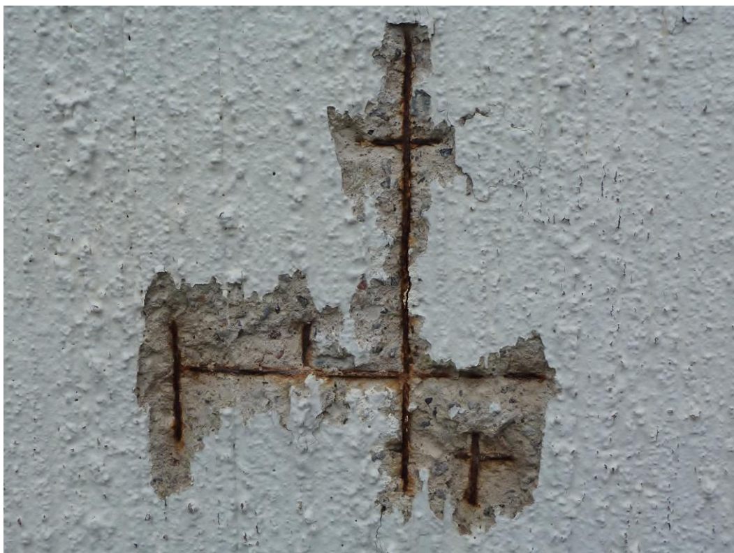
KUVIO 1. Terästen korroosion aiheuttamia vaurioita
