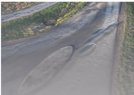
Figur 17. Här ser man hur felaktiga upphöjningar i asfalten har uppstått då skuggan av en skylt på trafikdelaren har förflyttat sig under flygningen.
