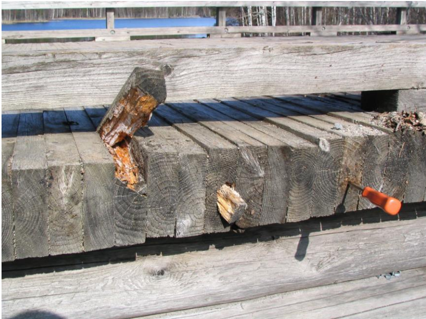
Kuva 5. Kuva Raikuun sillan lahonneesta kannesta (Liikennevirasto).
