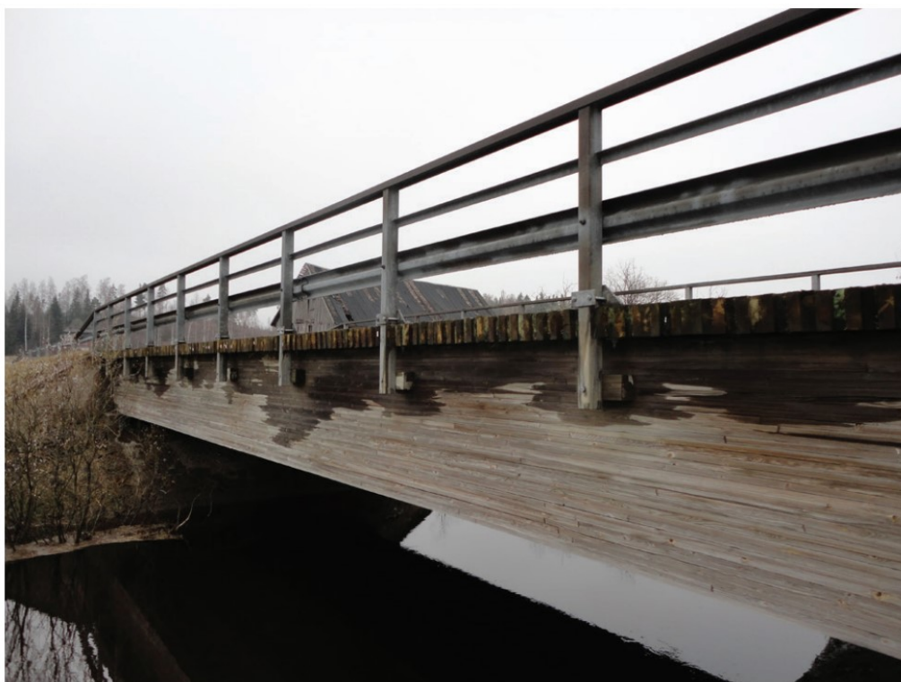
KUVA 5. Syrjälankkukannen rakoilun tai huonon vedenpoiston vuoksi pääkantajat voivat altistua kosteudelle (SILKO 1.401 2018)
