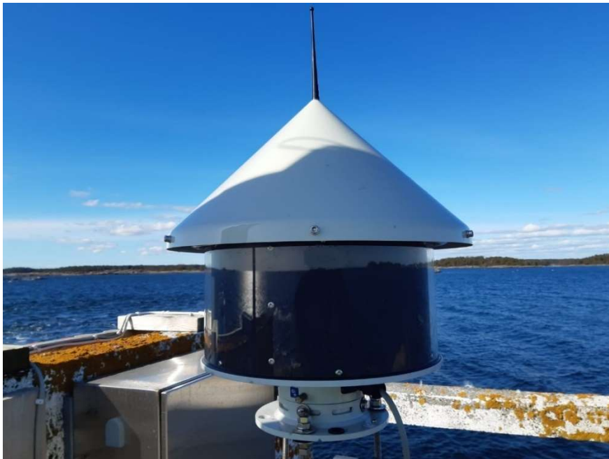
Kuva 8. ODSL valolaite betonirakenteen päällä.
