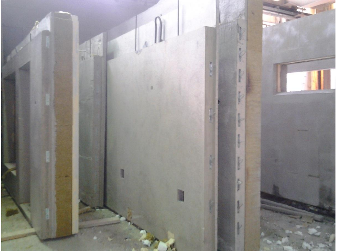
Kuva 8. Vieri viereen välivarastoitujen elementtien jälkitarkastusten tekeminen on hankalaa.
