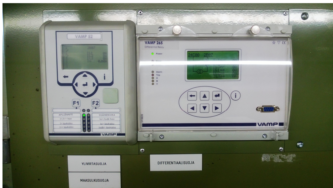
Kuva 2. Kennossa 07 suojaavat VAMP 52 ja VAMP 265 –suojareleet.
