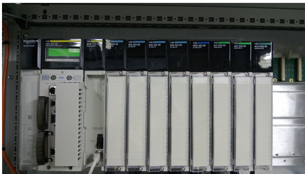
Kuva 14. PLC:n I/O-kortit johdotettuna kaapin riviliittimille
