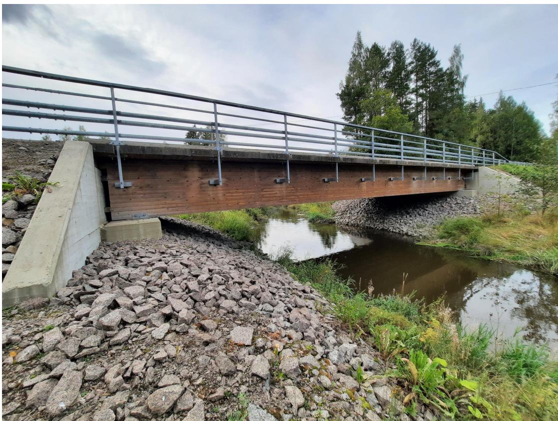
KUVA 2: Puinen palkkisilta, Haapajoen silta. (Taitorakennerekisteri: Tarja Särkiniemi, Ramboll Finland Oy 2021)
