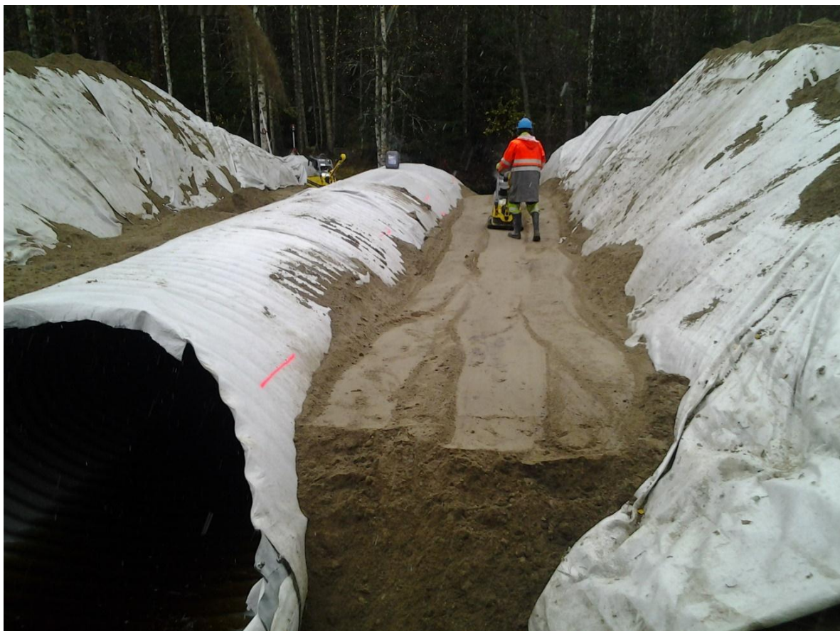
KUVA 9. Ruutananpuron täyttötyöt. Tiivistetään molemmilta puolilta tärylevyillä. Punainen viiva suodatinkankaassa on seuraavan tiivistyskerroksen raja. (Taskinen 2013-9-26).
