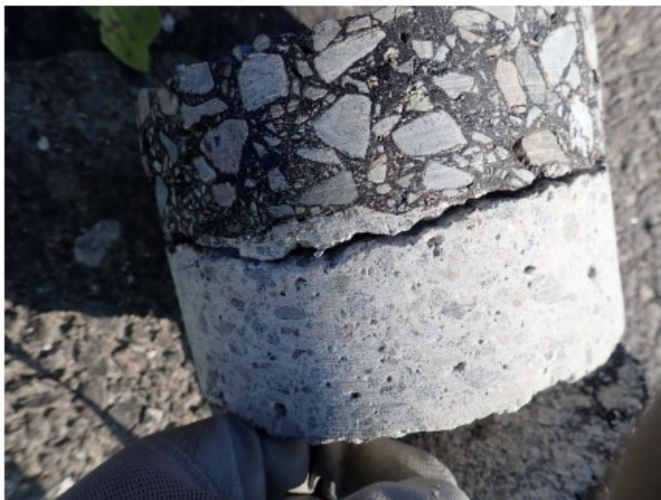
Päälysteen ja suojakerroksen kiinnittyminen sekä suojabetonin yläpinnan rapautuminen
