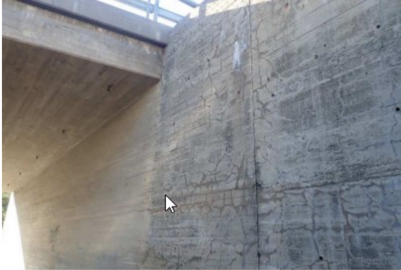
KUVA 4. Tyypillinen alusrakenteen AKR-vaurio (Väylävirasto 2020a)
