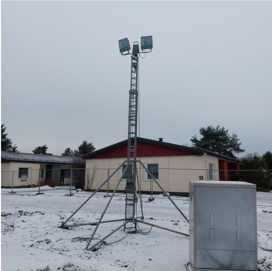
Kuva 8. Satakruunun rakennustyömaan valomasto.
