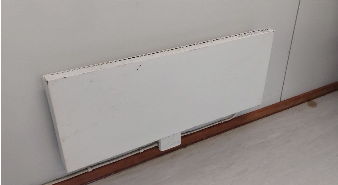
Kuva 7. Taukotilan 1000 W:n sähköpatteri.
