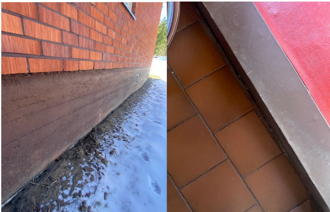
Kuva 10 ja 11. Rakennuksen vierustaa sekä lattian ja oven karmin sauma auki.
