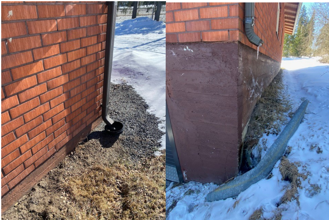
Kuva 12 ja 13. Uusittu ja vanha sadevesien poistojärjestelmä.
