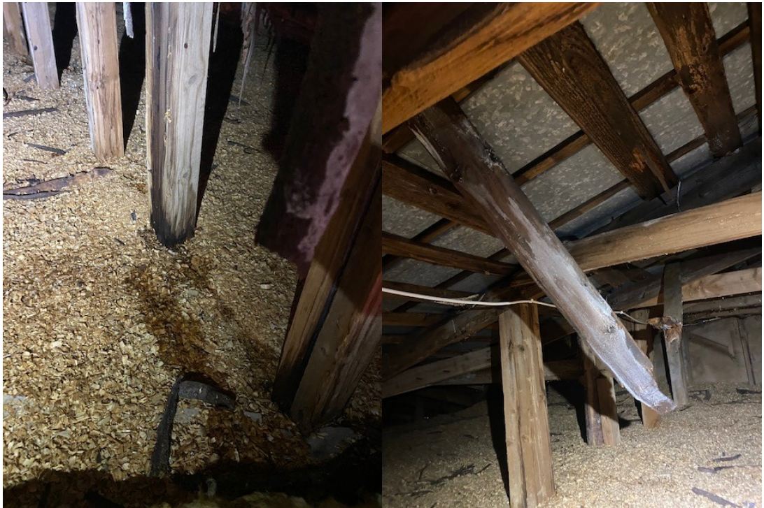
Kuva 20 ja 21. Yläpohjan kosteusvaurio näkyvissä eristeessä ja ruoteiden lahoaminen.
