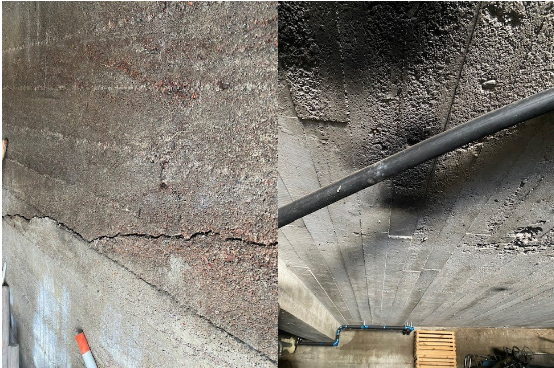
Kuva 8 ja 9. Perusmuurin halkeama ja kantava alapohja.
