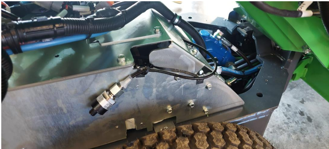
KUVA 15. Toimilaittepumpun paineanturi (Kuva: Tatu Ollikainen 2023).
