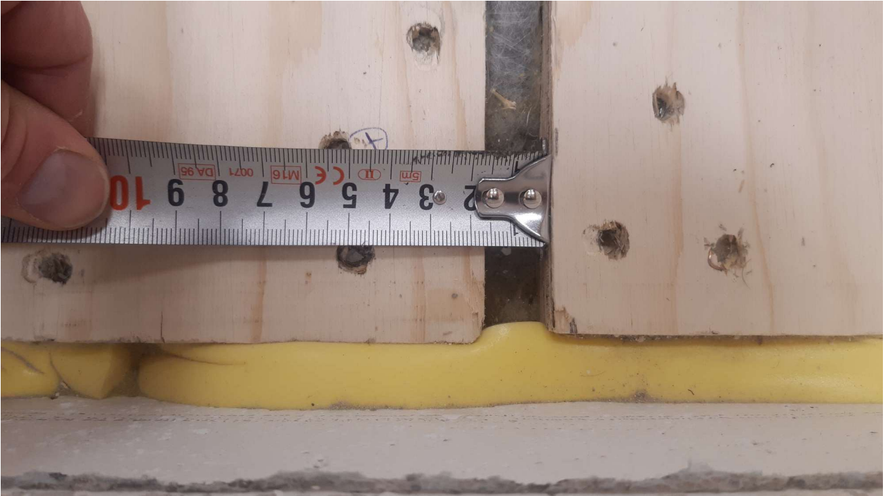
Kuva L3.10. Avokoteloelementtien välinen rako (villa) ja elementin tiivistys testiaukon laitaan (sylomer).
