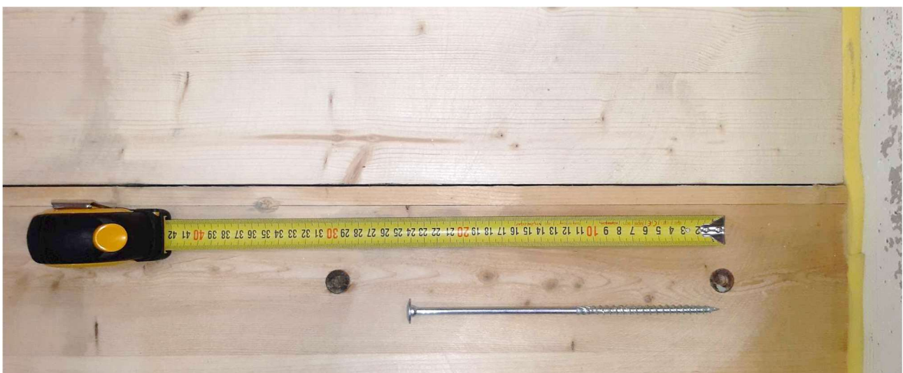
Kuva L3.14. CLT-elementit ruuvattiin toisiinsa pontin kohdalta käyttäen 240x7 mm leveäkantaista puuruuvia 300 mm välein. Oikealla näkyy laatan ja testausaukon välisen raon tiivisteenä käytetty pehmeä sylomeri-nauha.
