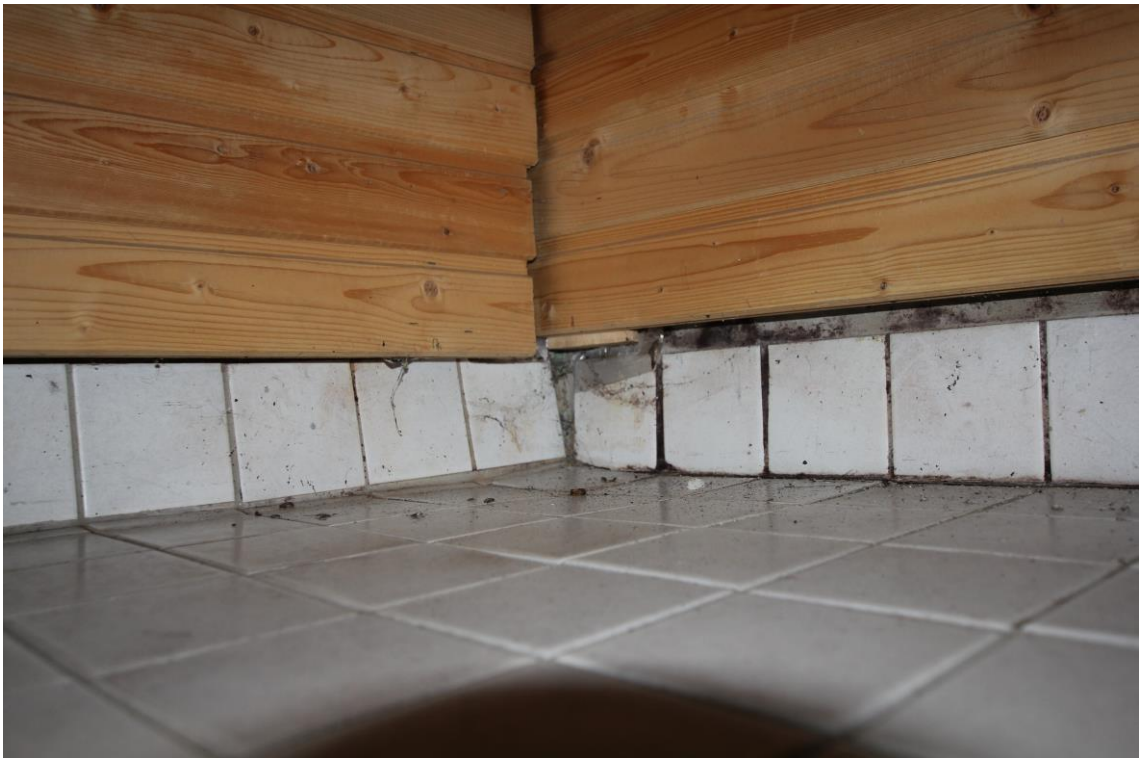
Kuva 10. Saunan lattian nurkassa korkeita kosteusarvoja ja laatat huonossa kunnossa.
