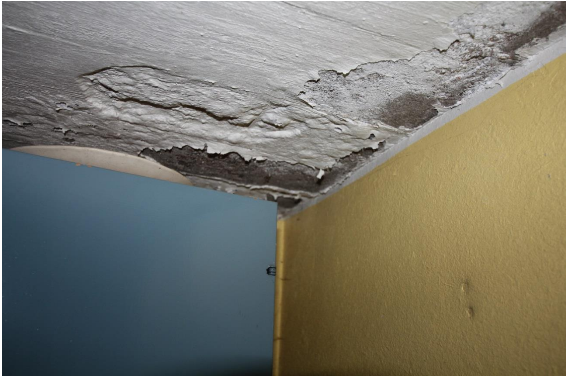
Kuva 5. Välipohjan pintamaali on irronnut kellarissa. Betoni on myös vaurioitunut.
