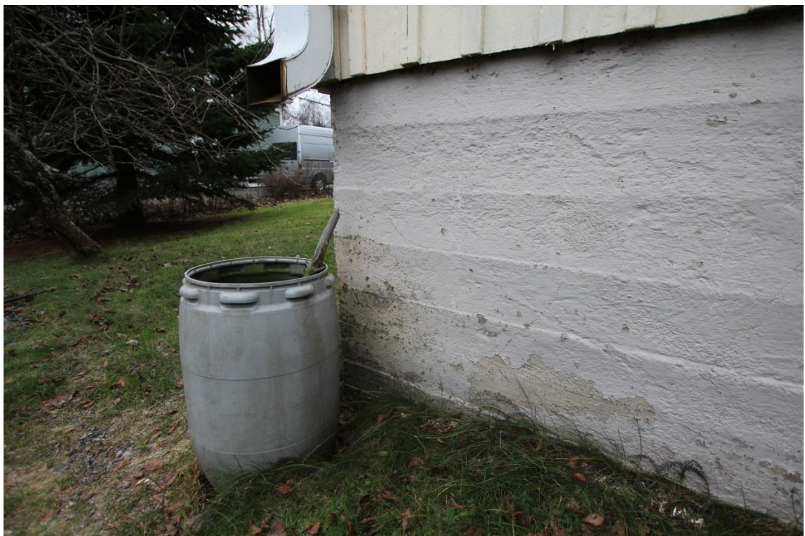
Kuva 1. Sadevedet ohjataan rakennuksen seinustalla olevaan tynnyriin.
