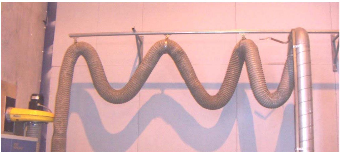
Kuva 22 Haitariletku ja imuri
