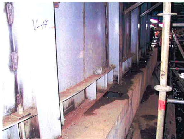
Kuva 13. Liuotinsäiliö on ankkuroitu alla olevaan betonilaattaan
